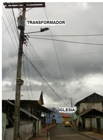
Figura 30. Energía eléctrica para OLT
