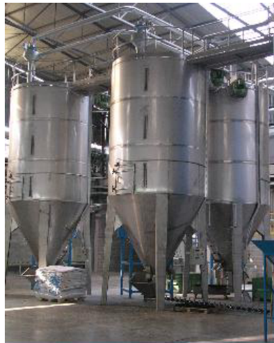
Gráfica 8.8 Silos para almacenamiento para PET
