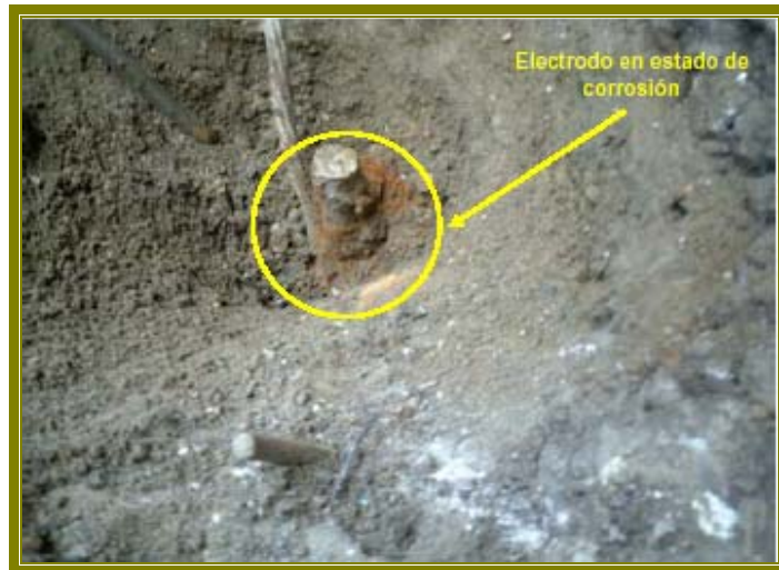
Figura 2.44 Electrodo en estado de corrosión.
