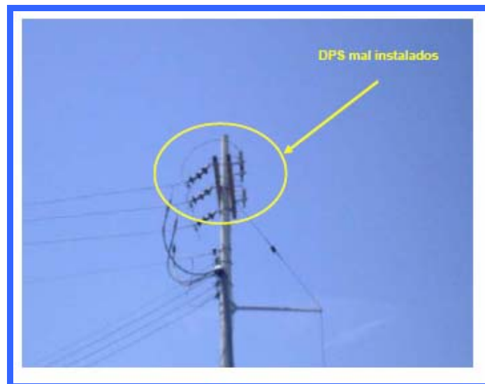
Figura 2.51 DPS mal instalado.
