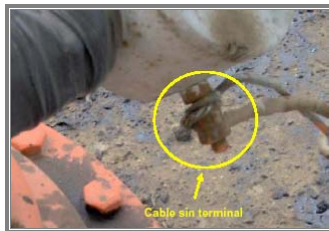
Figura 2.41 Cable sin terminal.
