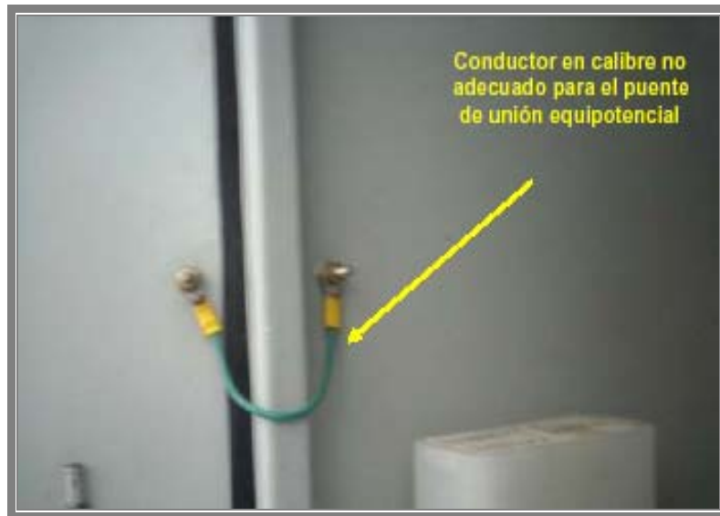
Figura 2.33 Conductor con calibre no adecuado
