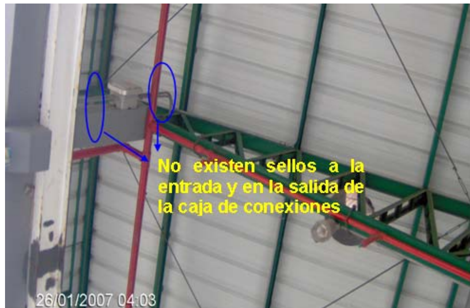
Figura 2.28 No existen sellos a la entrada ni en la salida de la caja de conexiones.
