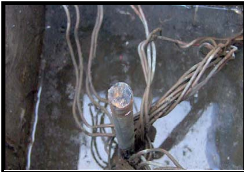
Figura 2.13 Varillas de tierra se conectan a malla por medio de conectores no certificados.
