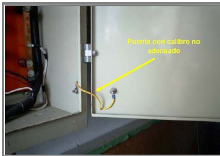
Figura 2.53 Puente con calibre no adecuado.
