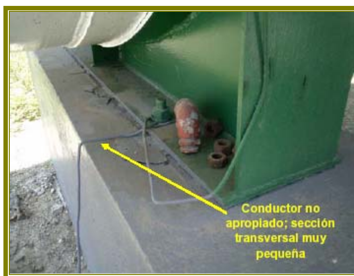
Figura 2.46 Conductor no apropiado; sección transversal muy pequeña.
