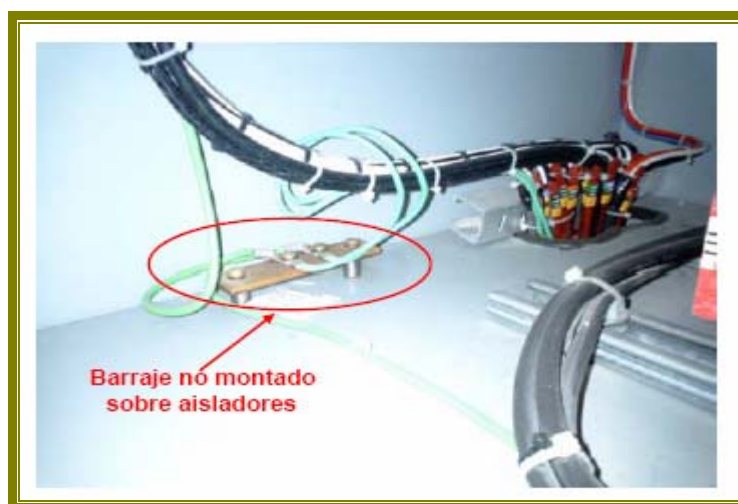
Figura 2.9 Barrajes de tierra conectados al chasis sin aisladores
