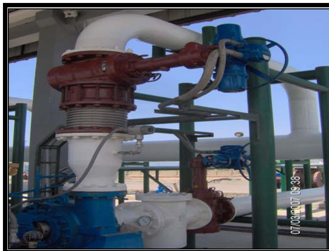
Figura 3.4 Área de bombas
