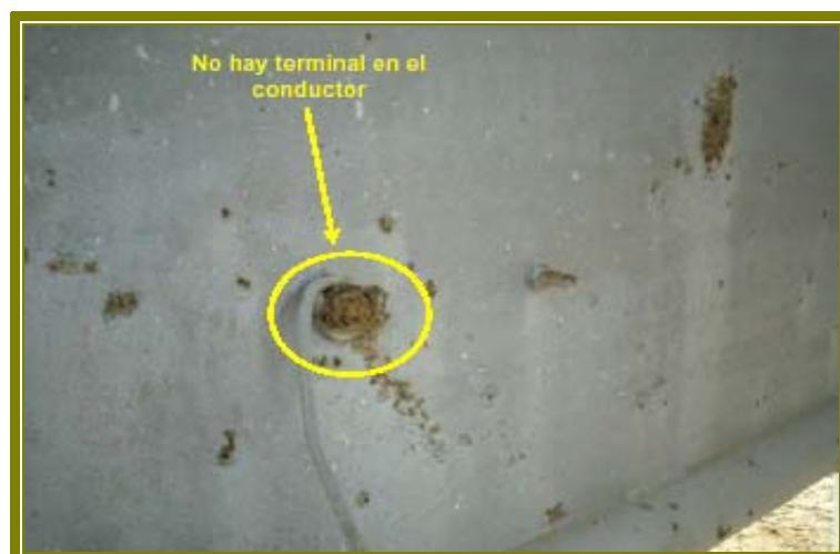
Figura 2.45 No hay terminal en el conductor.
