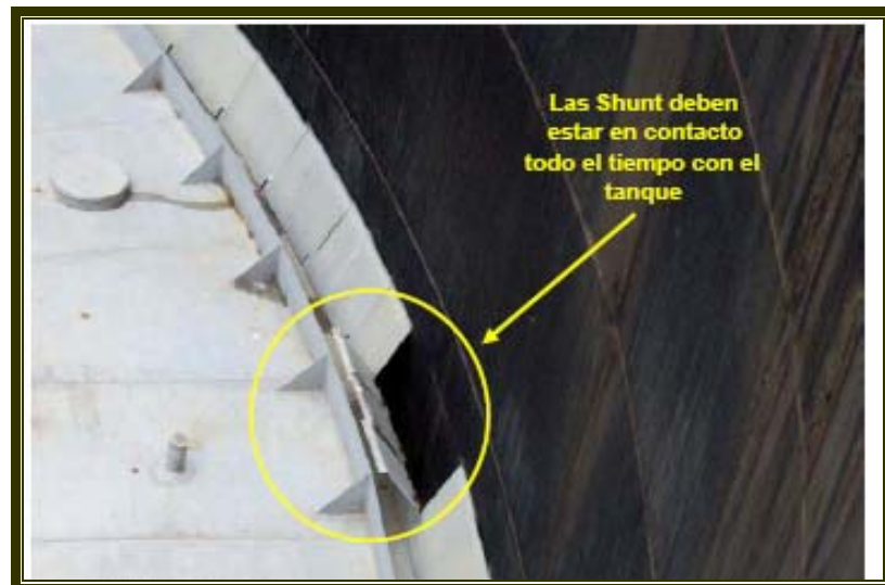
Figura 2.23 Las shunt deben estar todo el tiempo en contacto con el tanque.
