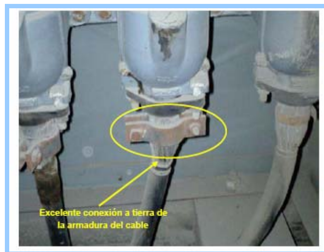
Figura 2.7 Excelente conexión a tierra de la armadura del cable
