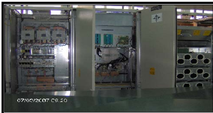
Figura 3.3 Centro de control de motores
