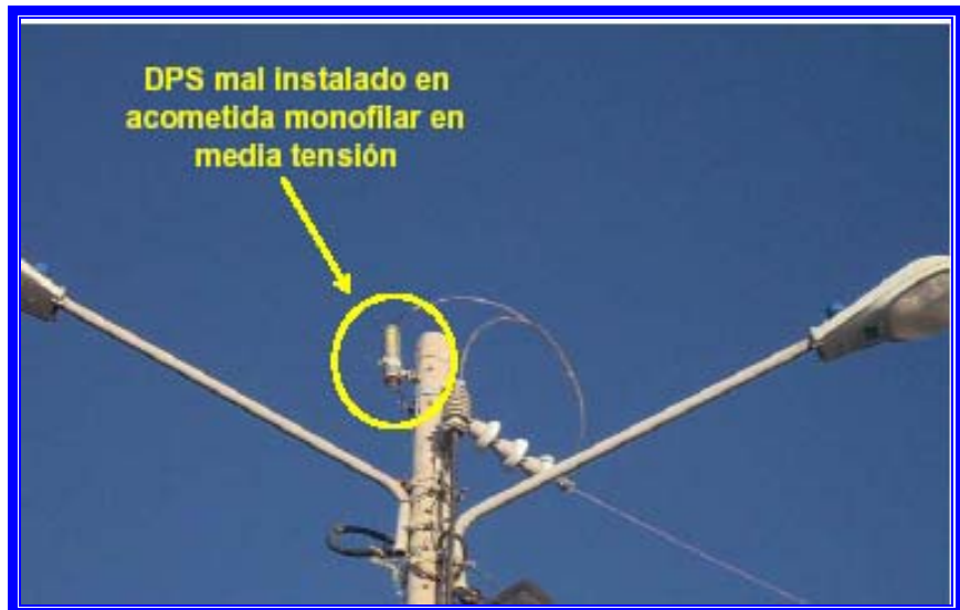
Figura 2.50 DPS mal instalado.
