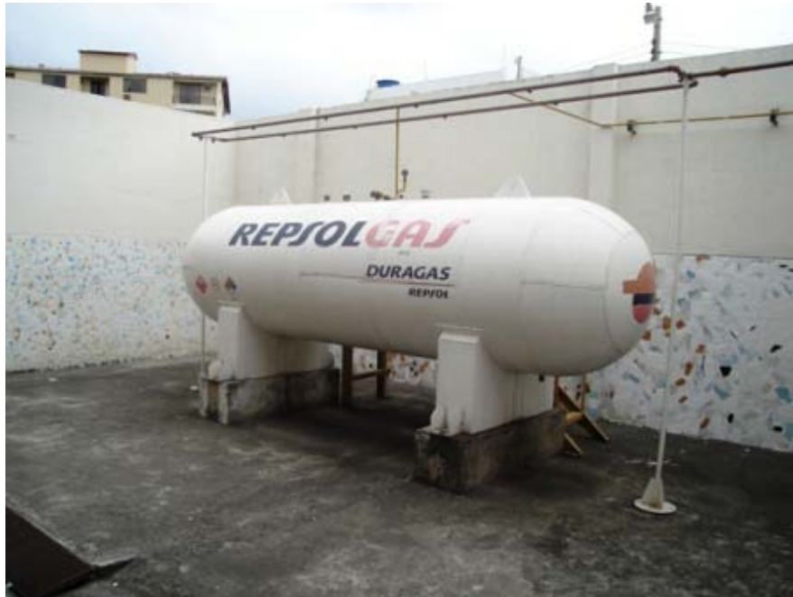
Figura 3-6 Tanque de gas
