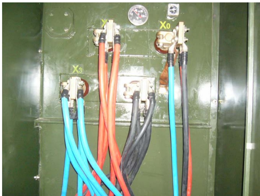
Figura 5.7 Terminales de lado de baja tensión
