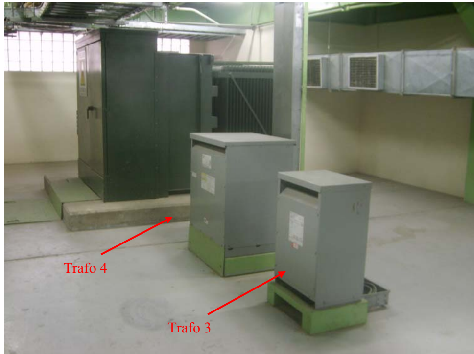
Figura 1.7 Cuarto de transformadores (transformadores secos).
