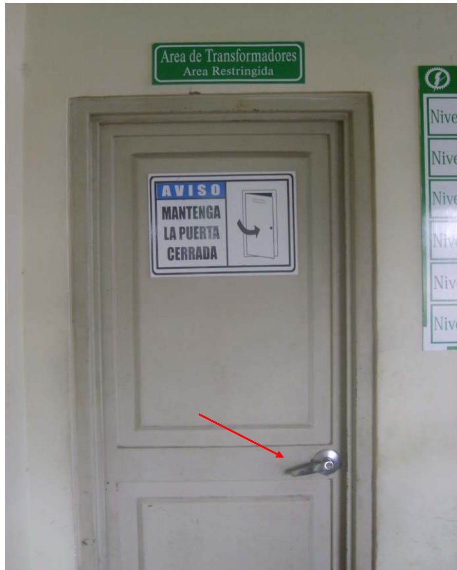
Figura 5.15 Cerraduras no adecuadas
