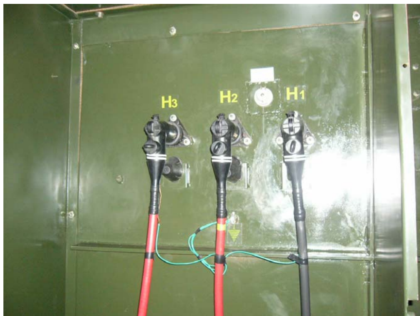
Figura 5.6 Terminales de lado de alta tensión
