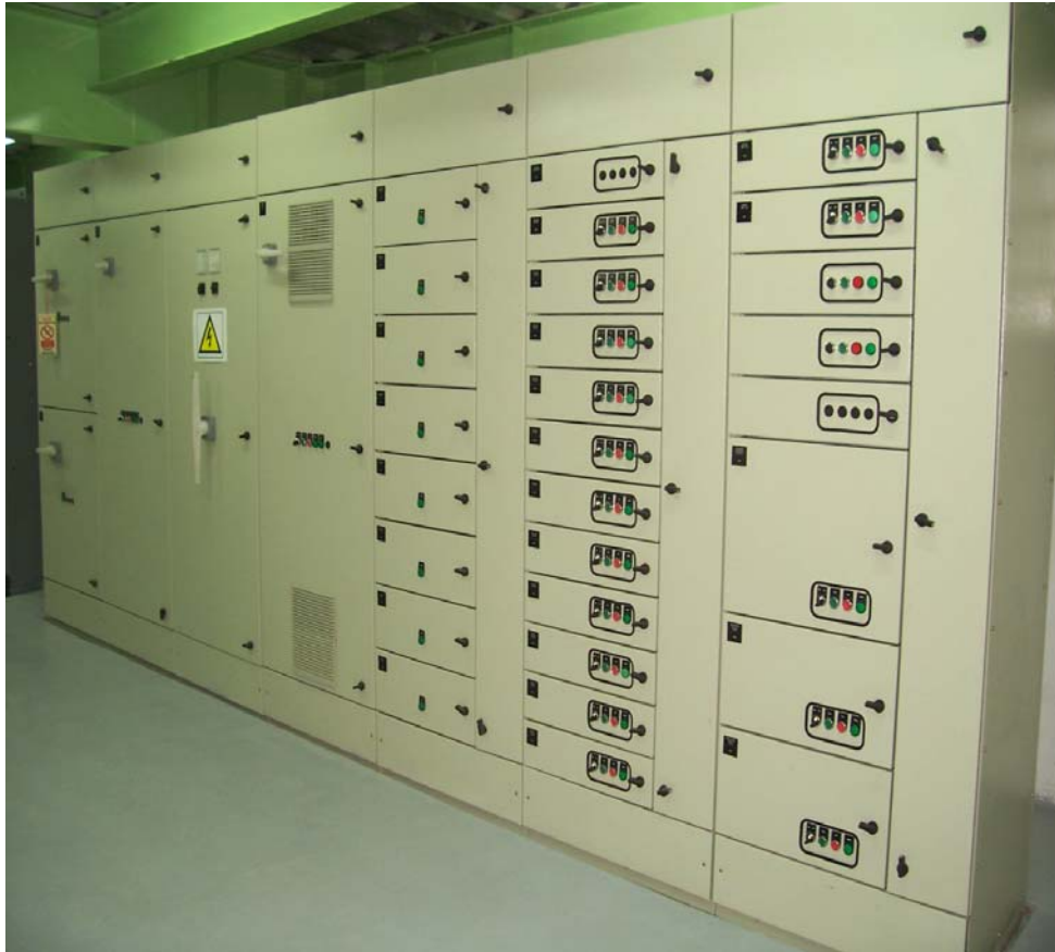
Figura 6.5 Tablero del CCM
