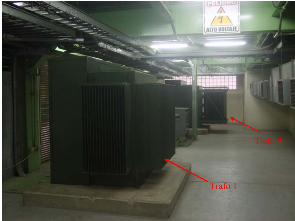
Figura 1.6 Cuarto de transformadores.
