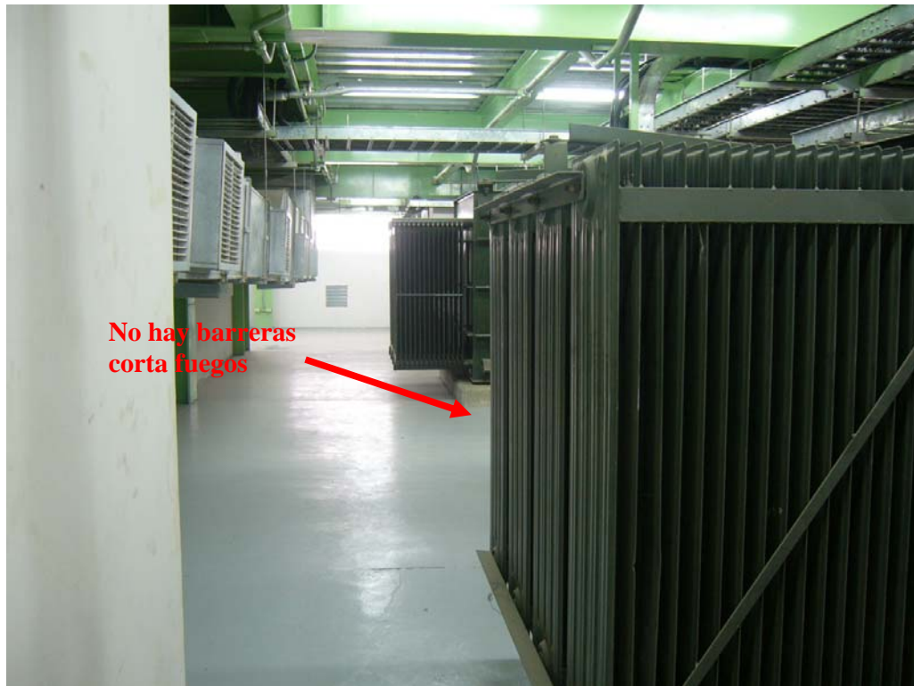
Figura 5.5 Vista del transformador
