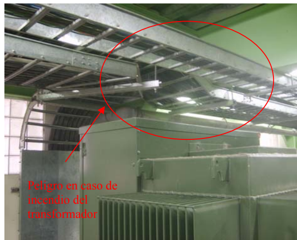
Figura 1.4 Canaletas y transformador
