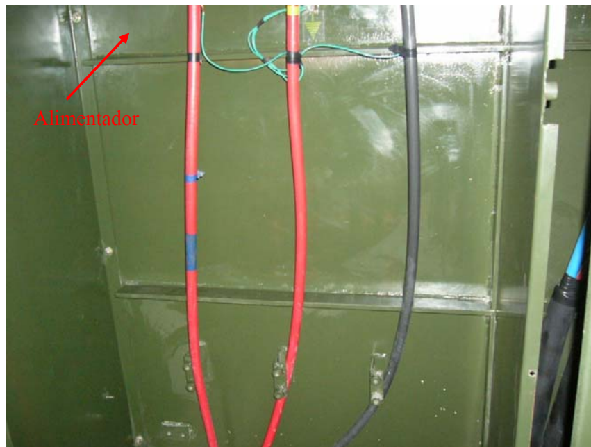
Figura 1.11 Cables del alimentador.
