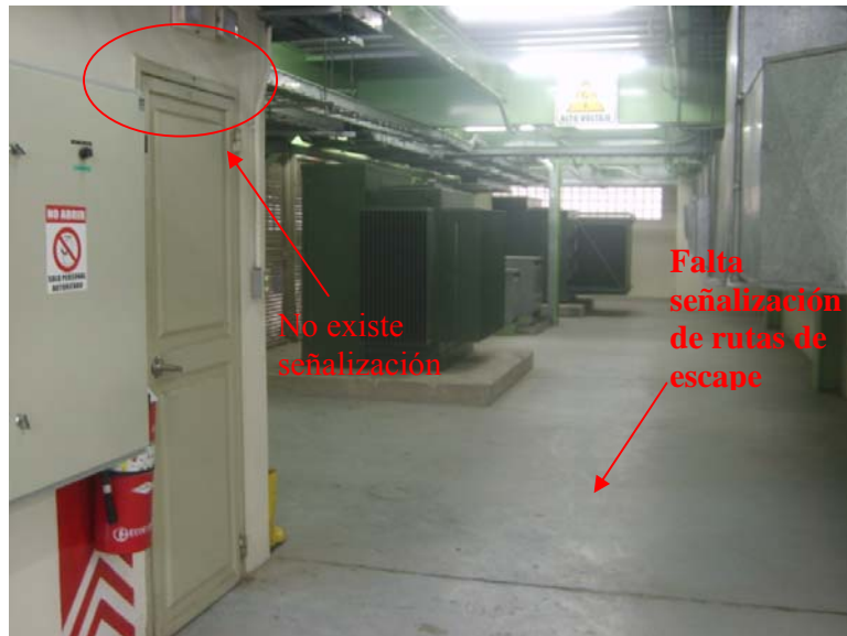
Figura 1.2 Cuarto de transformadores
