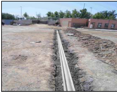
Figura N° 2.32 Canales de drenaje
