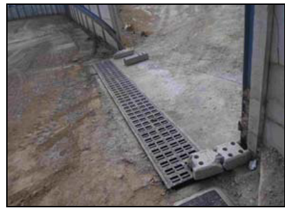
Figura N° 2.33 Rejilla para evacuación de agua
