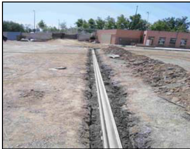
Figura N° 2.32 Canales de drenaje
