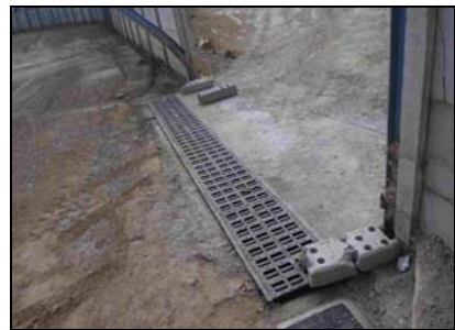
Figura N° 2.33 Rejilla para evacuación de agua
