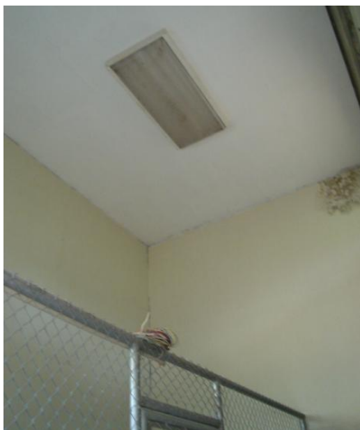
Figura 31. Iluminación mal ubicada en subestación eléctrica “C/T 21”.
