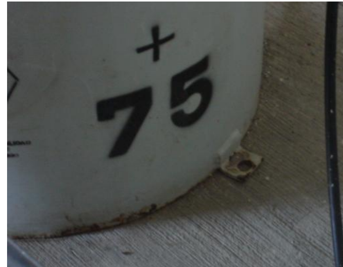
Figura 36. Corrosión en base de transformadores.
