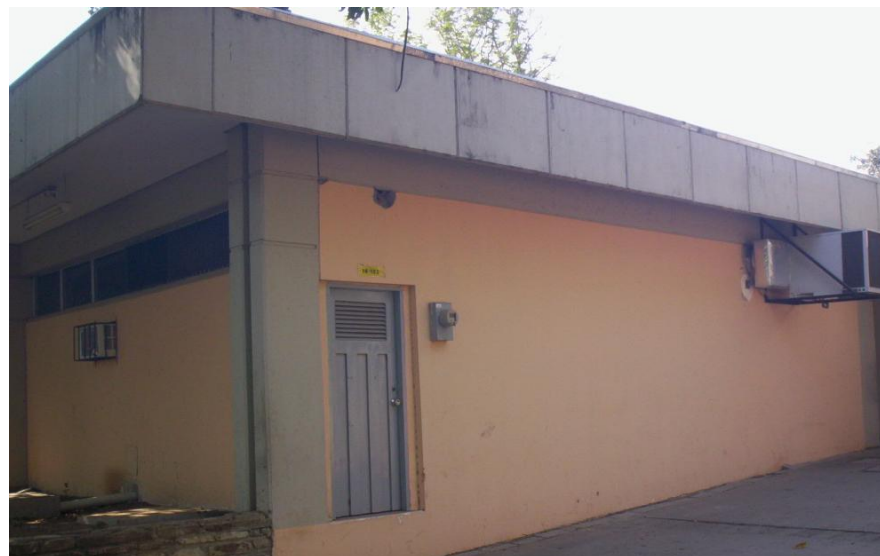
Figura 32. Aberturas de ventilación en subestación eléctrica “C/T 22”.
