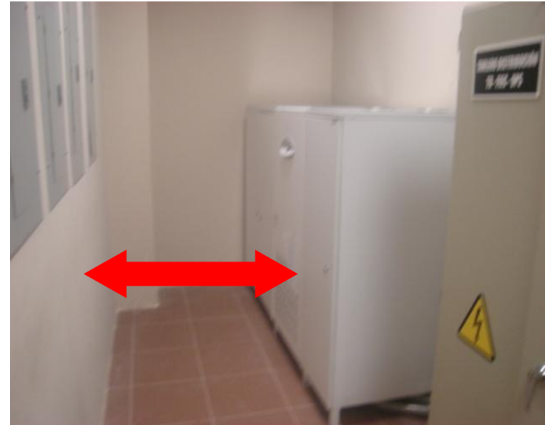
Figura 28. Dimensiones incorrectas en cuarto Distribución de subest. elect. tipo Padmounted.
