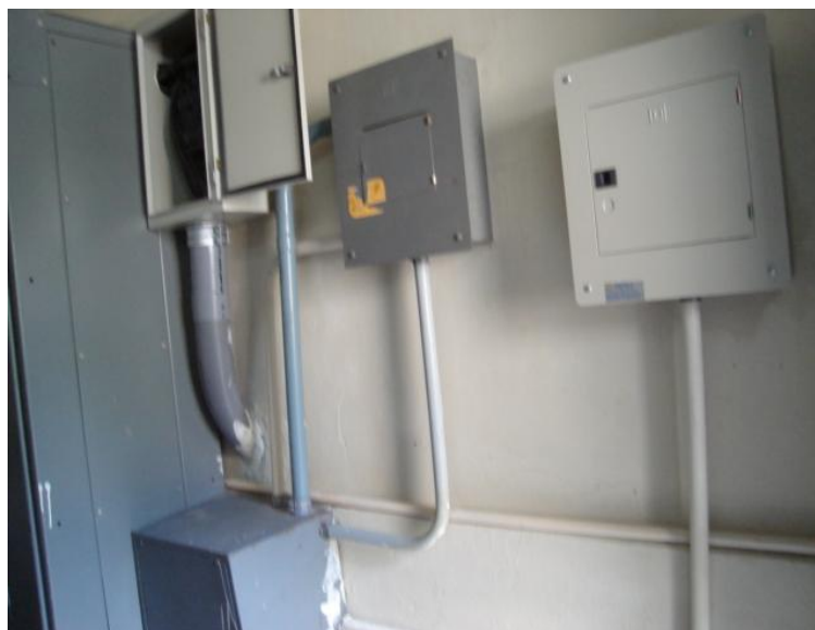
Figura 15. Tablero de distribución en subestación eléctrica “C/T22”.
