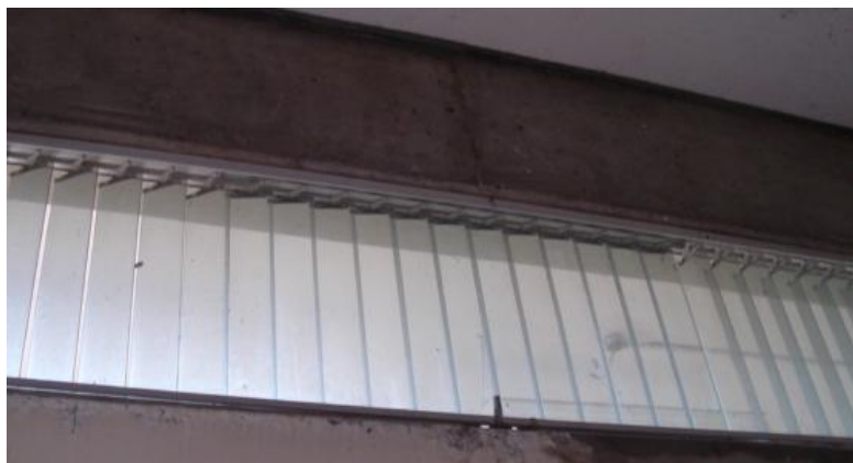
Figura 33. Celosías para ventilación en subestación eléctrica "C/T 22"
