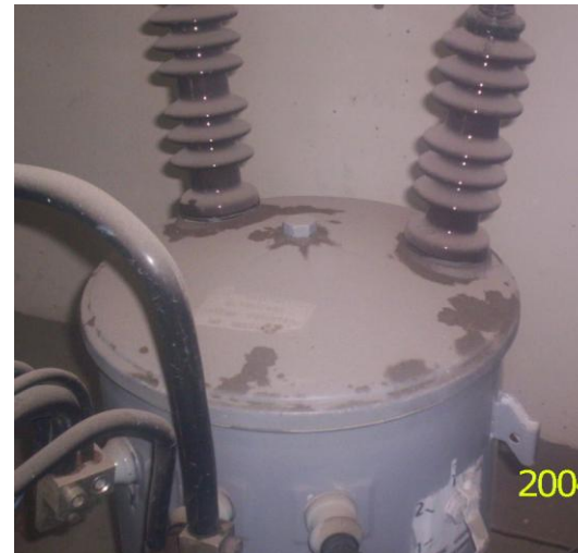
Figura 26. Presencia de polvo por falta de limpieza.
