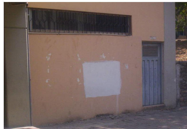
Figura 34. Aberturas de ventilación en subestación eléctrica "C/T 21".
