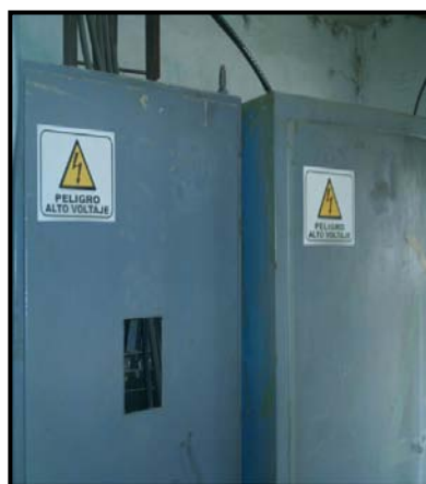
FIGURA 1.8 Tableros de distribución subestación REPLASA
