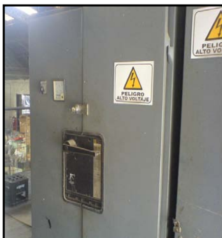
FIGURA 1.7 Tablero Principal de subestación REPLASA
