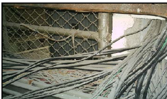
FIGURA 1.9: Acumulación de polvo en conductores
