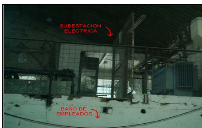
FIGURA 5.1 Ubicación de Subestación Eléctrica.
