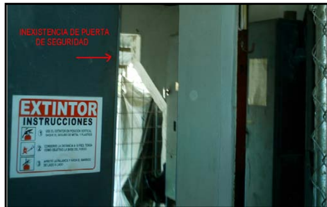
FIGURA 5.5 Falta de puerta de seguridad en cuarto de tableros.
