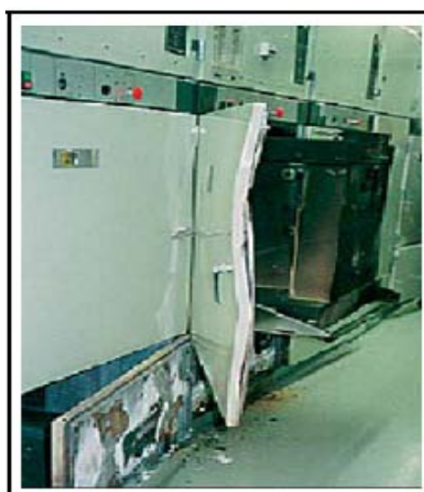
FIGURA 2.6 Consecuencia producida por una explosión
