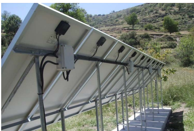
Figura 3.34. Estructura y Soportes para los Módulos Fotovoltaicos
