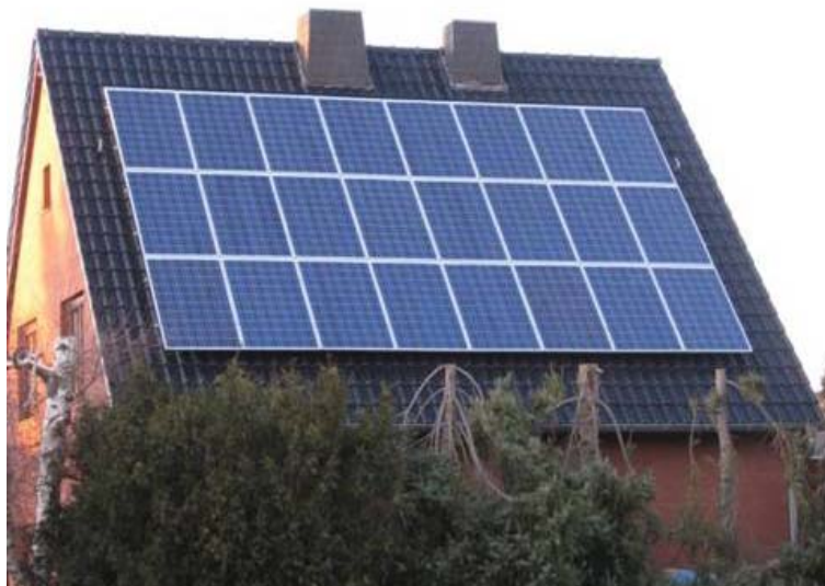
Figura 3.7. Instalación Fotovoltaica casera
