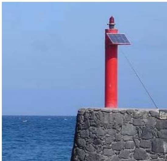
Figura 2.1. Instalación fotovoltaica en faros
