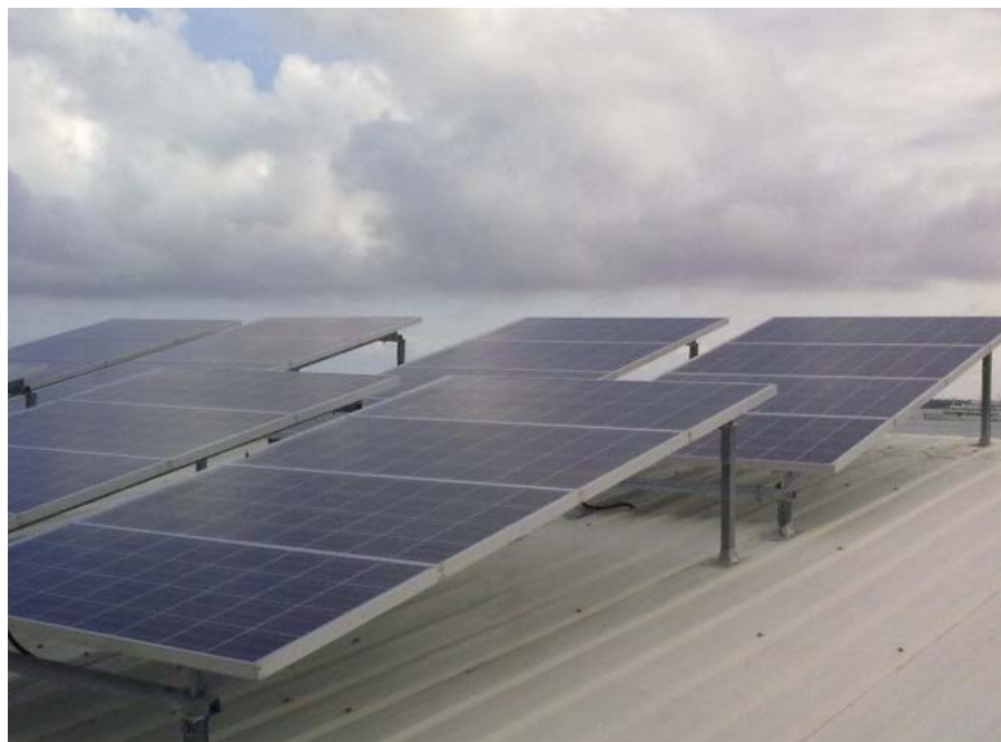
Figura 4.1. Paneles Fotovoltaicos instalados en la “Estación Científica Charles Darwin”.
