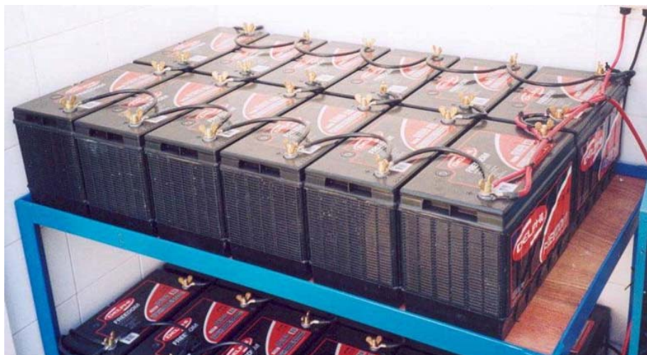
Figura 3.29. Banco de Baterías para sistemas Fotovoltaicos
