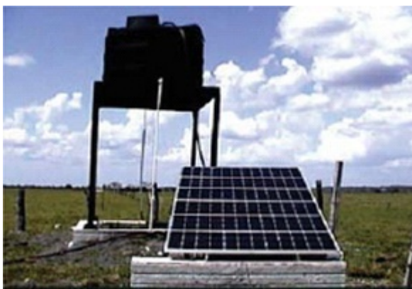
Figura 4.9. Sistema de Bombeo de Agua por Sistema Fotovoltaico
