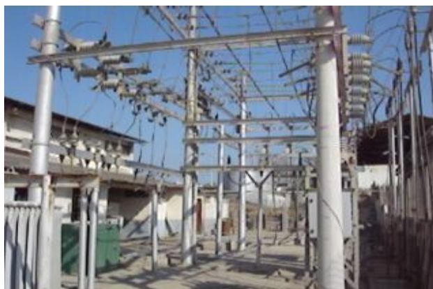
Figura 3.1 Vista de pórtico de 13.8 kV
