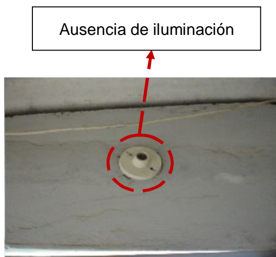
Figura 3.6 Iluminación del cuarto de transformadores
