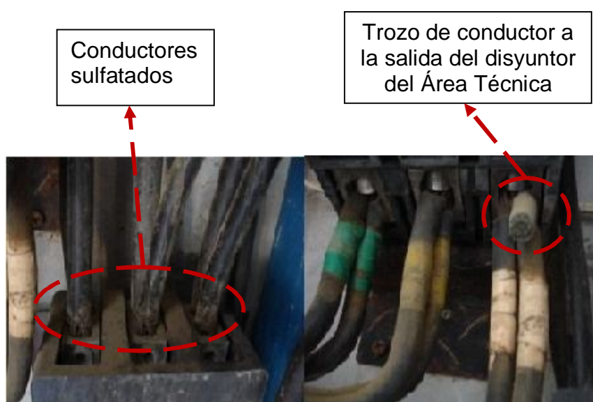
Figura 3.9 Disyuntores de Planificación y Área Técnica
