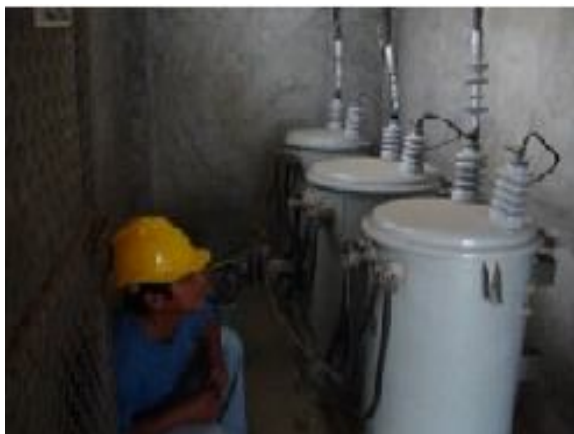
Figura 3.10 Toma de datos en la placa de los transformadores
