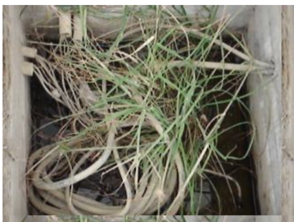
Figura 3.11 Conductores en contacto con el agua y maleza
