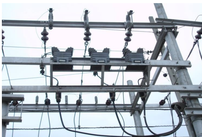
Figura 3.2 Alimentadores desde el pórtico de 13,8 kV al banco de transformadores.
