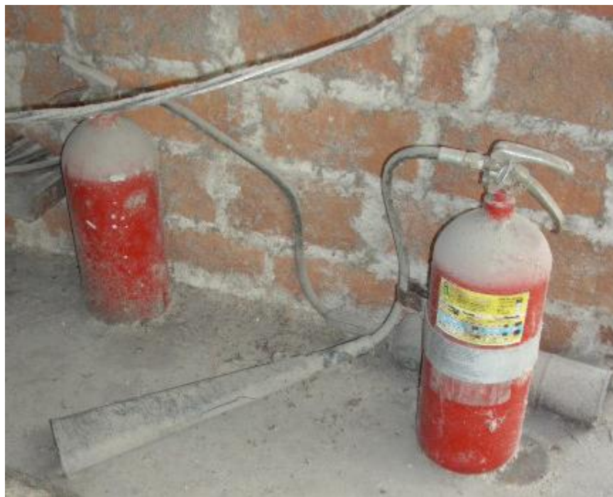
Fig. 5: Extintores en el suelo [8]
