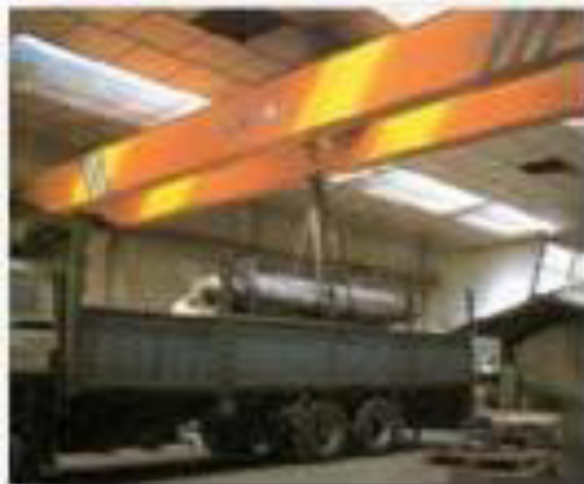
FIG. 2.9 PUENTE GRUA DE 25 TON (Cortesía Intermetal)
