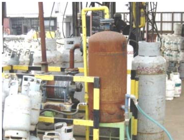
FIGURA 2.4. BOMBA DE VACÍO JUNTO A TANQUE COLECTOR EN SISTEMA NO. 2.
