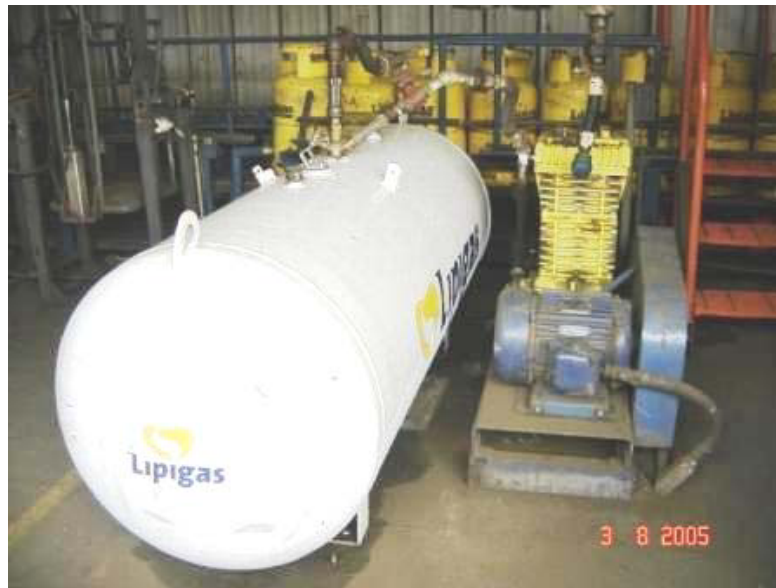
FIGURA 2.3 TANQUE COLECTOR JUNTO A COMPRESOR DE GLP DEL SISTEMA NO. 1.
