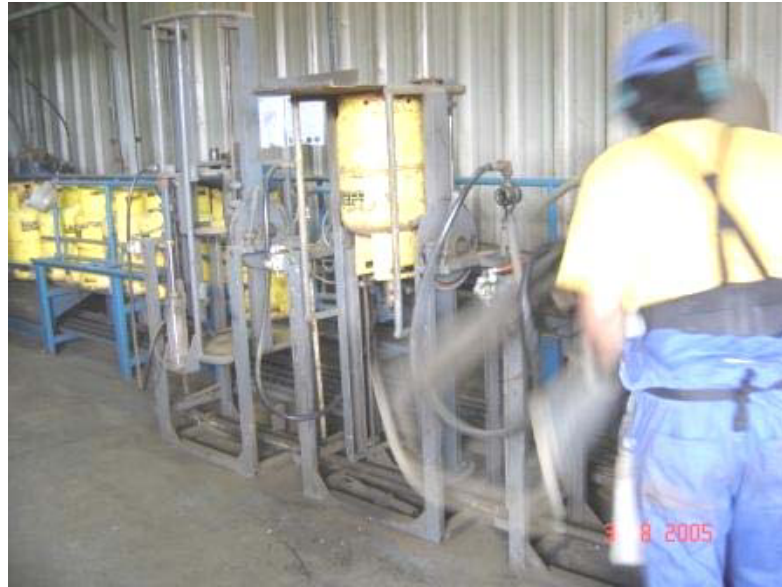
FIGURA 2.1 MAQUINA VOLTEADORA PARA EXTRACCIÓN DE GLP LÍQUIDO EN SISTEMA NO. 1.
