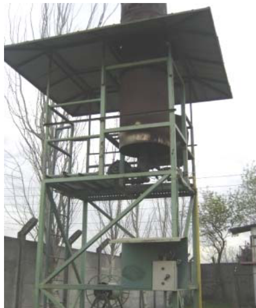
FIGURA 2.6 TORRE CON ANTORCHA PARA QUEMA DE GLP RESIDUAL DEL SISTEMA NO. 2.
