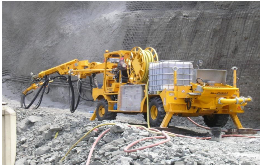
Figura 3.3. Colocación de Hormigón Proyectado en los taludes de los portales del túnel.
