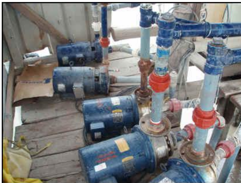
FIGURA 3.24 BOMBAS DE AGUA DEL MUELLE
