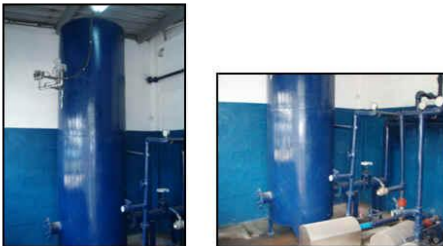
FIGURA 3.26 TANQUE DE PRESIÓN DE CISTERNA DE AGUA SALADA
