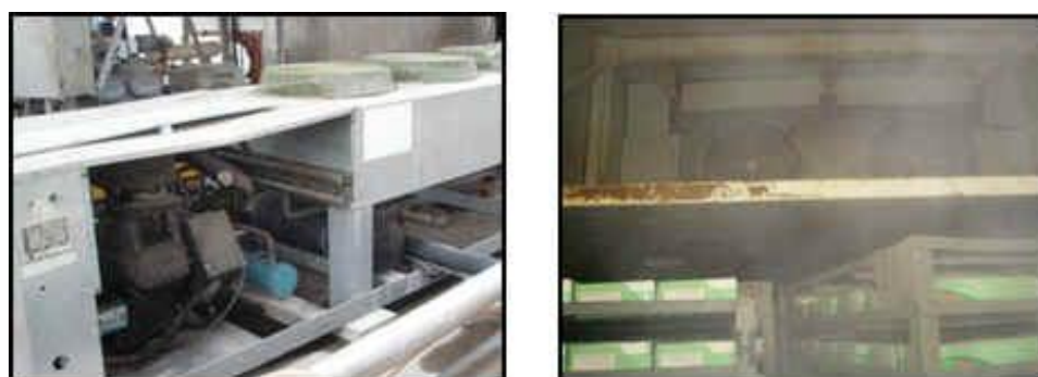
FIGURA 3.10 UNIDAD CONDENSADORA Y EVAPORADORES DEL TÚNEL #2
