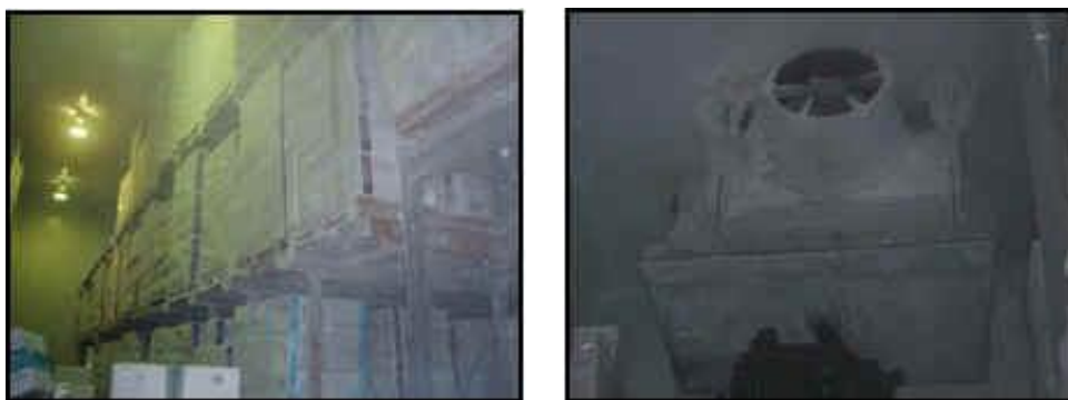
FIGURA 3.12 PERCHAS Y EVAPORADOR DE LA CÁMARA #4
