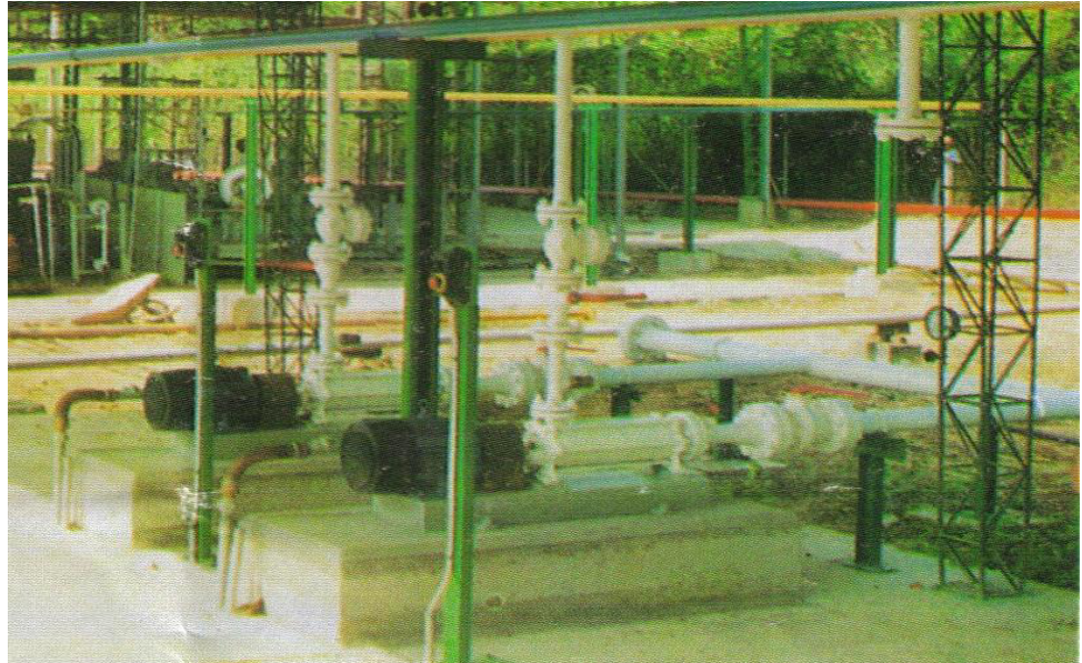
FIGURA 1.3. BOMBAS PARA EL TRASIEGO DEL GLP
