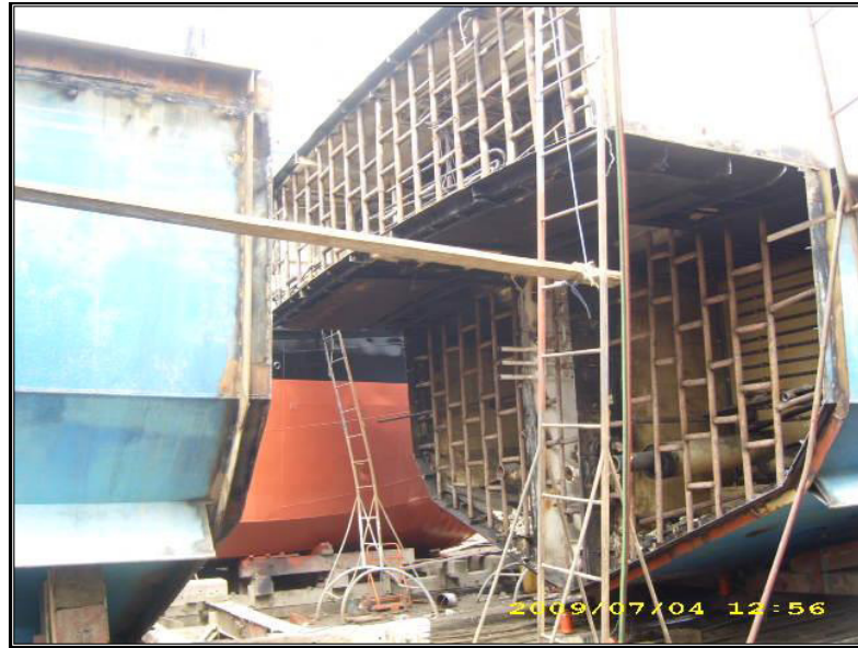
Figura 7.B. Desplazamiento de las mitades, en el área donde se insertó el bloque.
