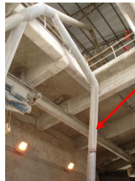
FIGURA 4.6. ENTRADA DE AIRE FALSO
