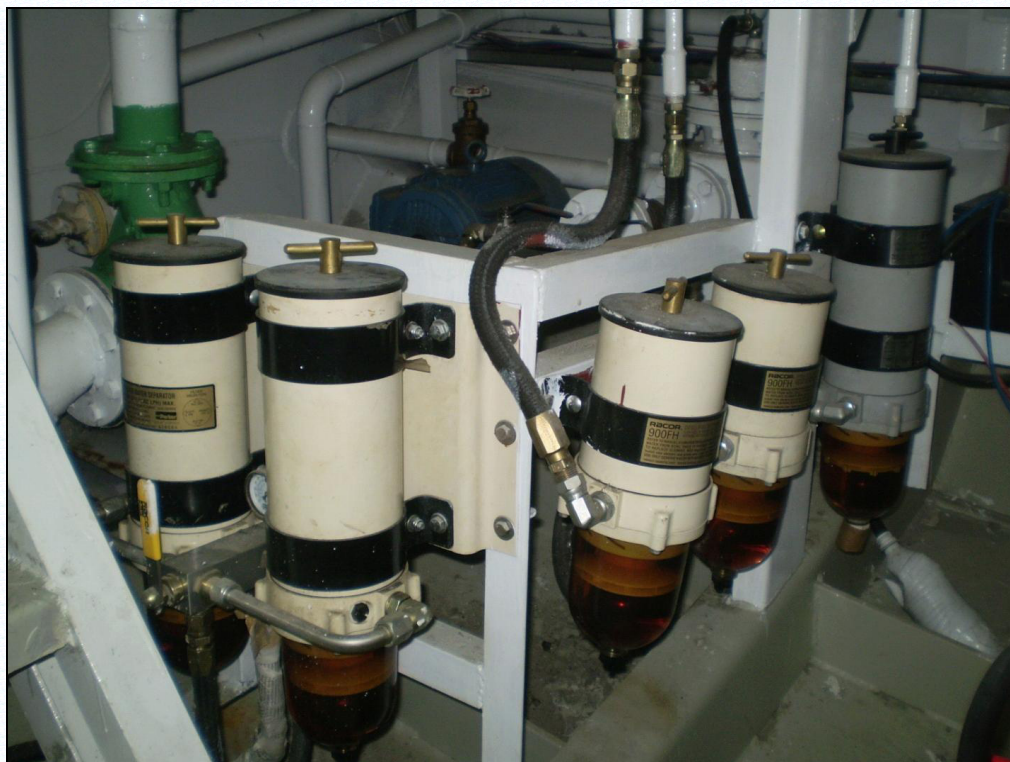
Figura No. 40. Banco de filtros raccor
