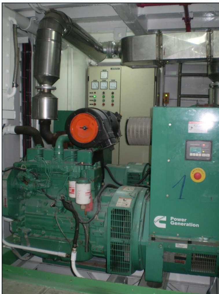
Figura No. 39. Generador Cummings
