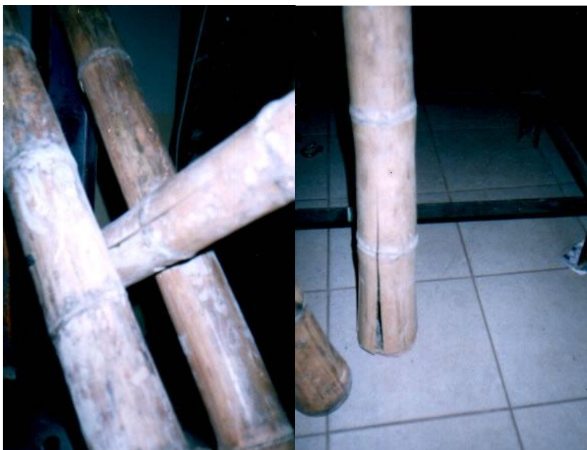
Figura 2.10 Falla de la caña longitudinalmente
