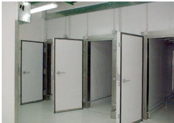
FIGURA 2.4 PUERTAS DE CÁMARAS.
