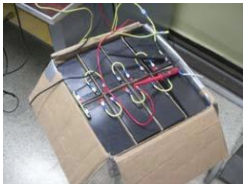
Figura 4: Banco de Baterías
