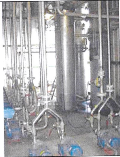
Bombas de torres de destilación
