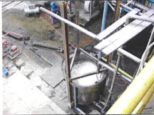
Tanque de Sulfitación
