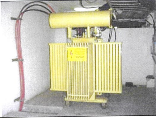
Transformador de entrada de 1250_KVA
