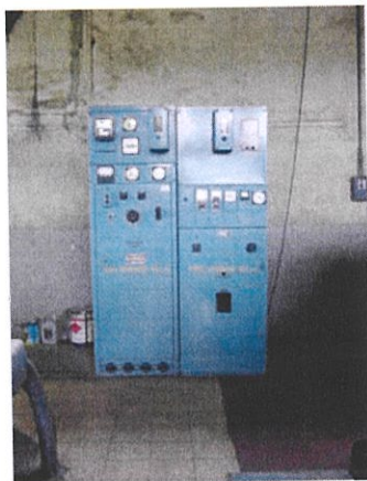
Equipo de control de turbogenerador de 350_KW
