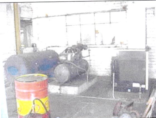
Compresores de aire
