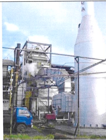
Caldera principal y colector de partículas en chimenea.
