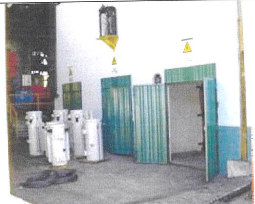
Área de transformadores
