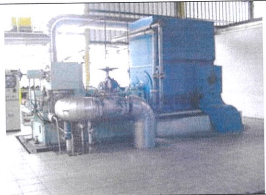
Turbogenerador de 2,500_KW
