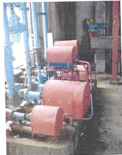
Motores y Bombas de jugos
