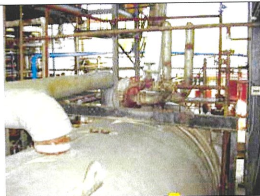
Caldera de destilería
