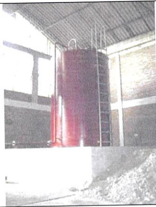
Depósito de ácido sulfúrico con dique
