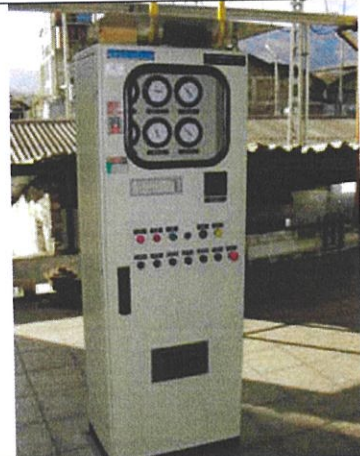
Equipo de control de turbogenerador de 2,500_KW
