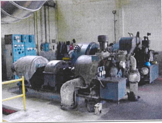
Turbogeneradores de 350_KW y 500_KW
