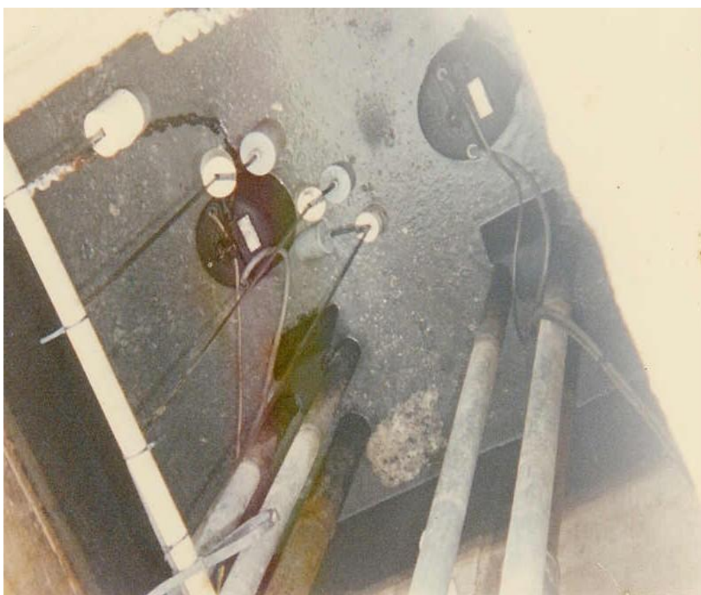
FIGURA 2.6: BOMBAS SUMERGIBLES EN FUNCIONAMIENTO
