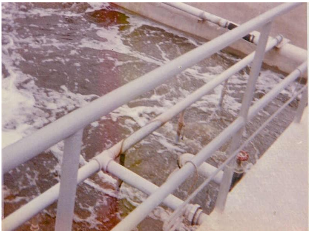
FIGURA 2.4: PUENTE DE MANIOBRAS Y LÍNEAS DE EFLUENTES
