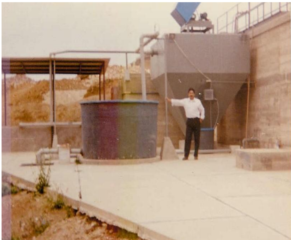
FIGURA 2.1: VISTA DE PLANTA INSTALADA.
