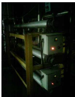
Fig. 3.8 Precalentador de Bunker
