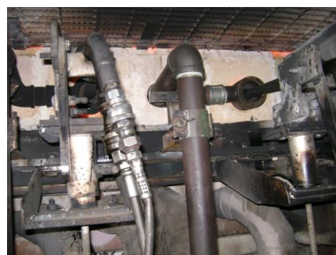
Fig. 3.14 Área de Quemadores
