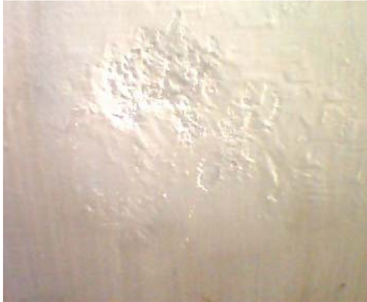
FIGURA 3-6. DISMINUCIÓN DE ESPESOR LOCALIZADA- TK 7
