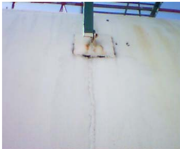
FIGURA 3-3. CORROSIÓN DEL SOPORTE DE LA PLATAFORMA- TK 2
