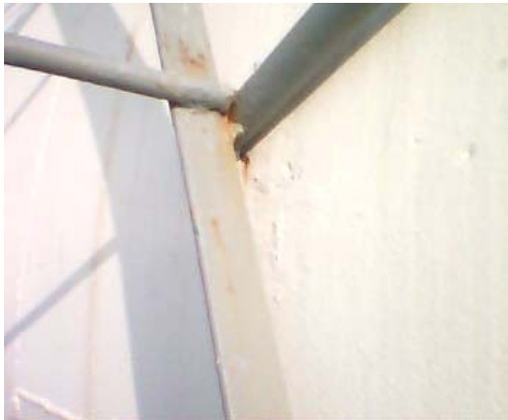
FIGURA 3-7. CORROSIÓN ENTRE ESCALERA Y TANQUE- TK 8
