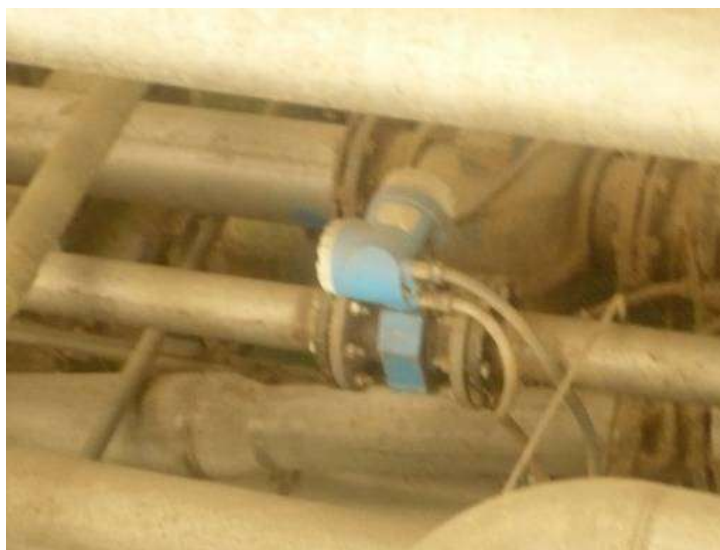
FIGURA 2.22: MEDIDOR DE FLUJO DE ALIMENTACIÓN DE FIBRA CORTA HACIA EL TANQUE DE MÁQUINA.
