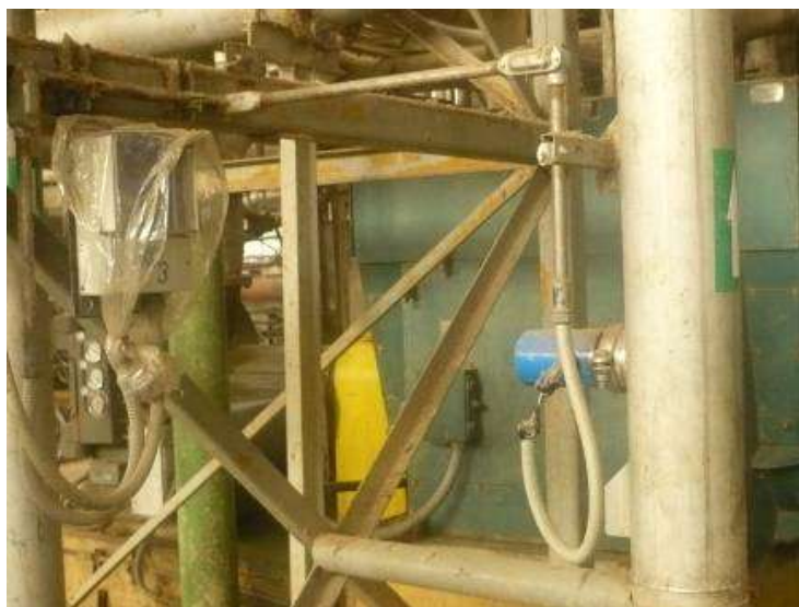
FIGURA 2.20: MEDIDOR DE CONSISTENCIA INSTALADO EN LA LÍNEA DE ALIMENTACIÓN AL REFINADOR DE FIBRA CORTA.
