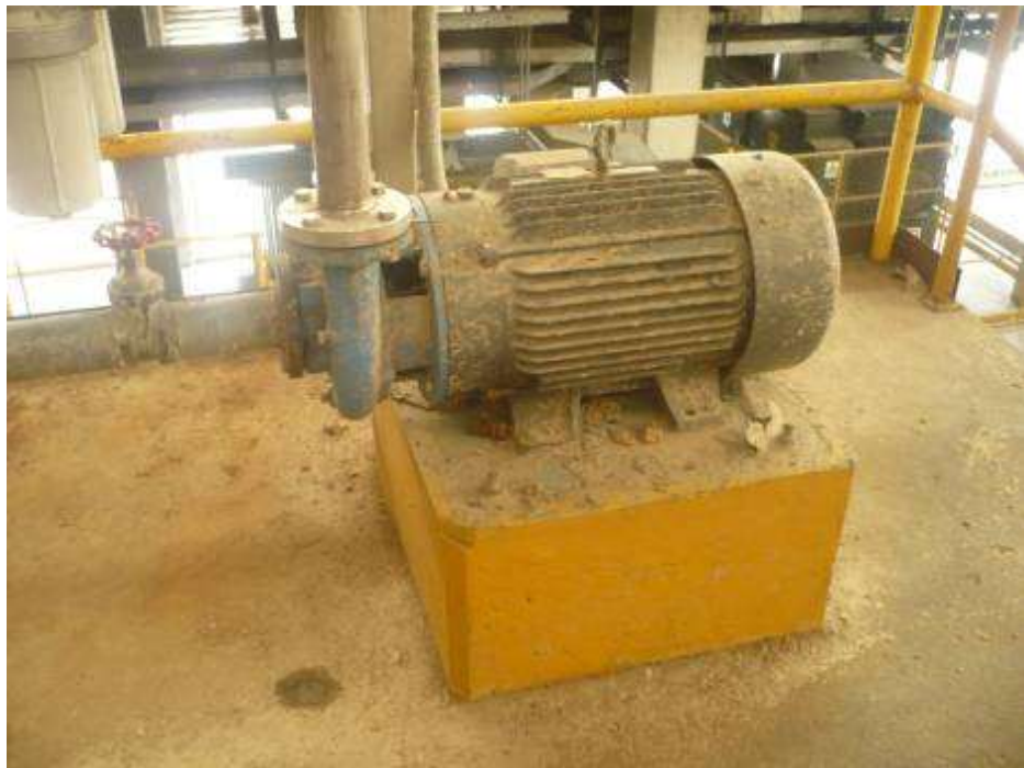
FIGURA 2.15 BOMBA DE DUCHAS DEL ESPESADOR.
