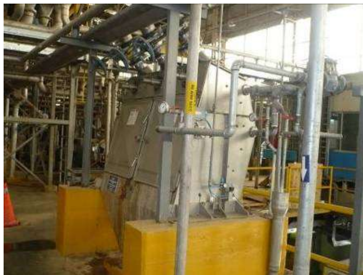
FIGURA 2.10 ESPESADOR DE FIBRA CORTA (INSTALACIÓN FINAL)
