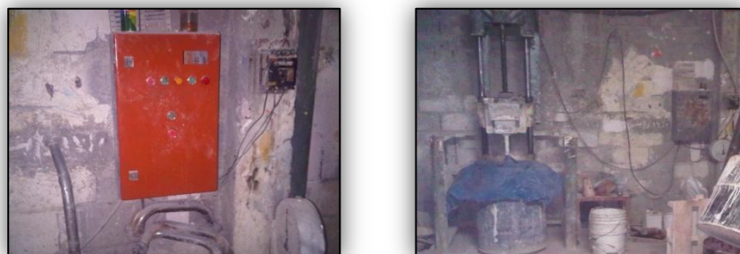
FIGURA 5.7. TABLERO DE CONTROL DE MÁQUINA MEZCLADORA
