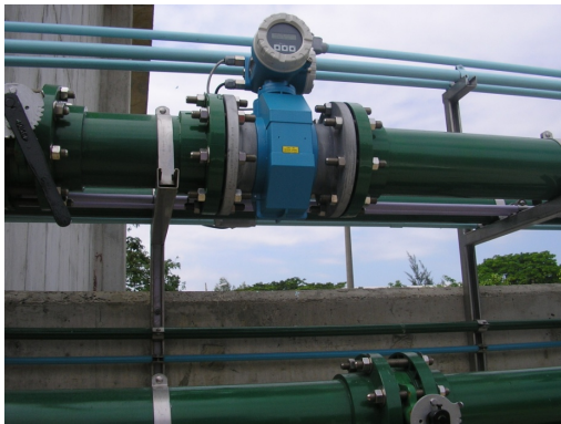
Figura 3-4: medidor de caudal, tubería de presión con accesorios.
