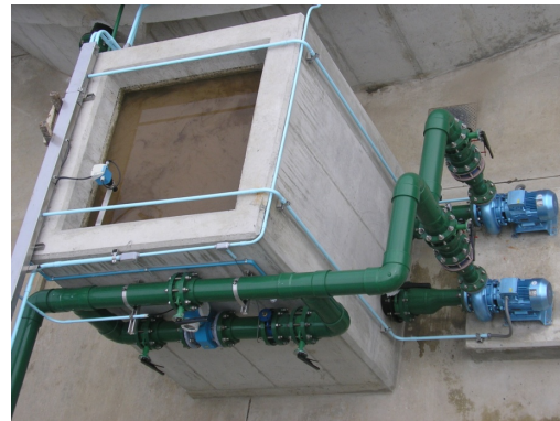
FIGURA 3-5: Tanque de lodos con accesorios.
