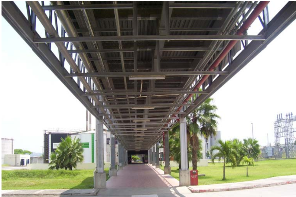
FIGURA 2.1 Iluminación de corredor de planta.
