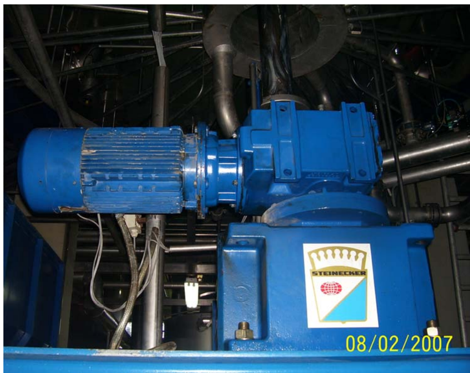
FIGURA 1.5 Sistema motor reductor de cuba filtro
