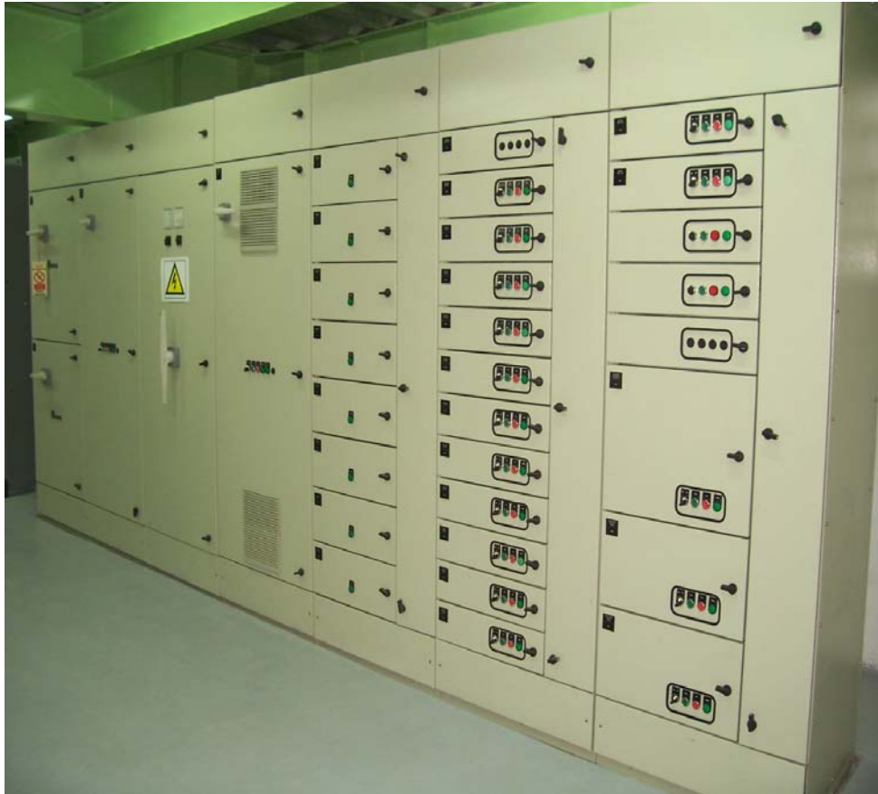
Figura 6.5 Tablero del CCM
