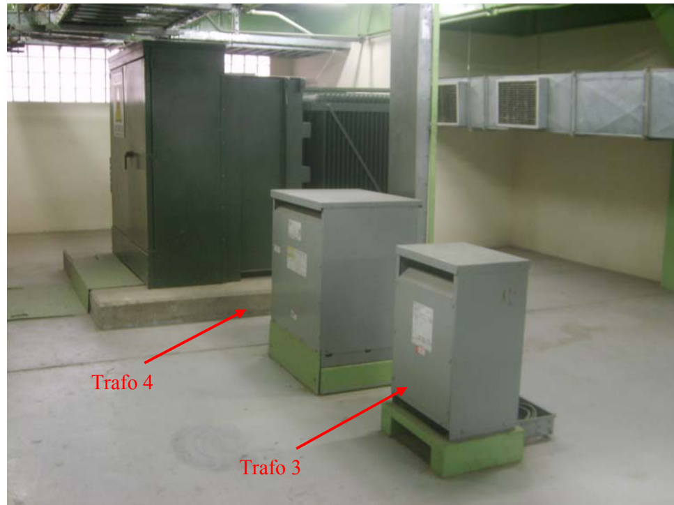
Figura 1.7 Cuarto de transformadores (transformadores secos).
