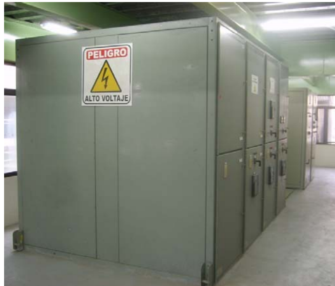
Figura 1.14 Celdas del Metalclad (switchgear)
