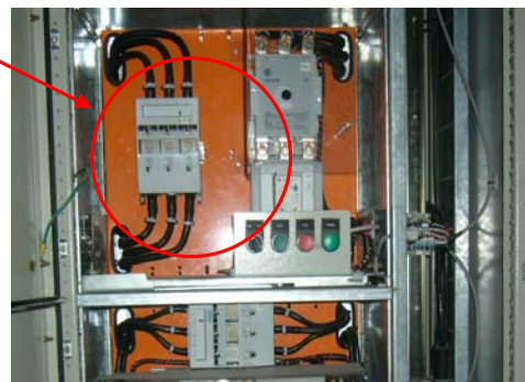
Figura 2.15 Breaker CCM Caldera
