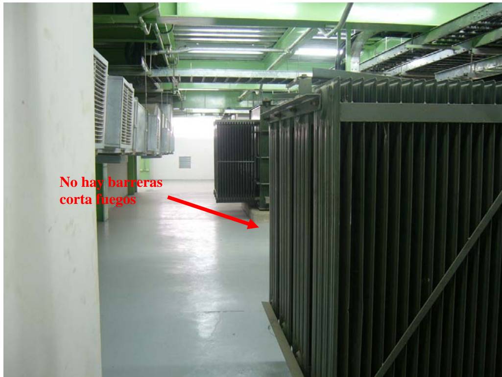
Figura 5.5 Vista del transformador
