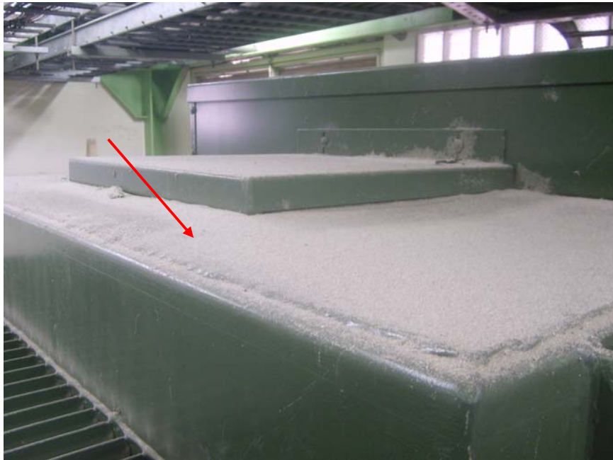
Figura 5.12 Acumulación de material sobre el transformador
