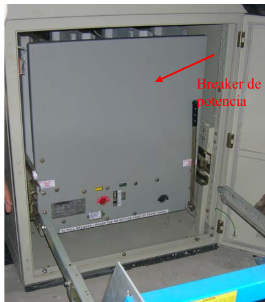
Figura 1.9 Breaker de potencia.
