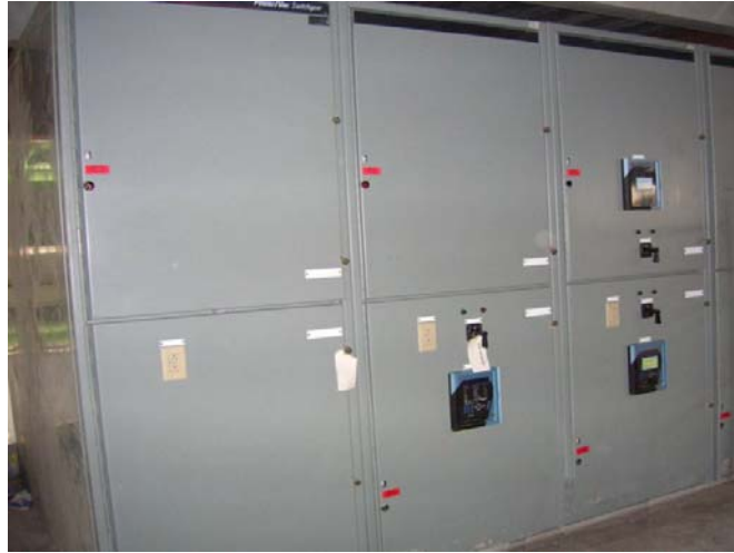
Figura 1.13 Celdas del Metalclad (switchgear)
