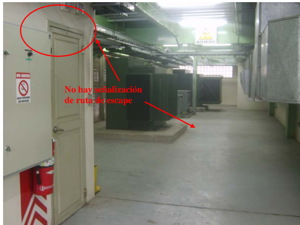
Figura 5.11 Ruta de escape no señalizada
