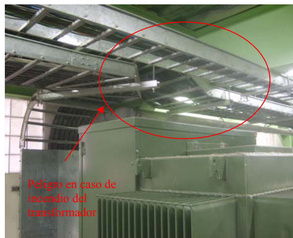
Figura 1.4 Canaletas y transformador
