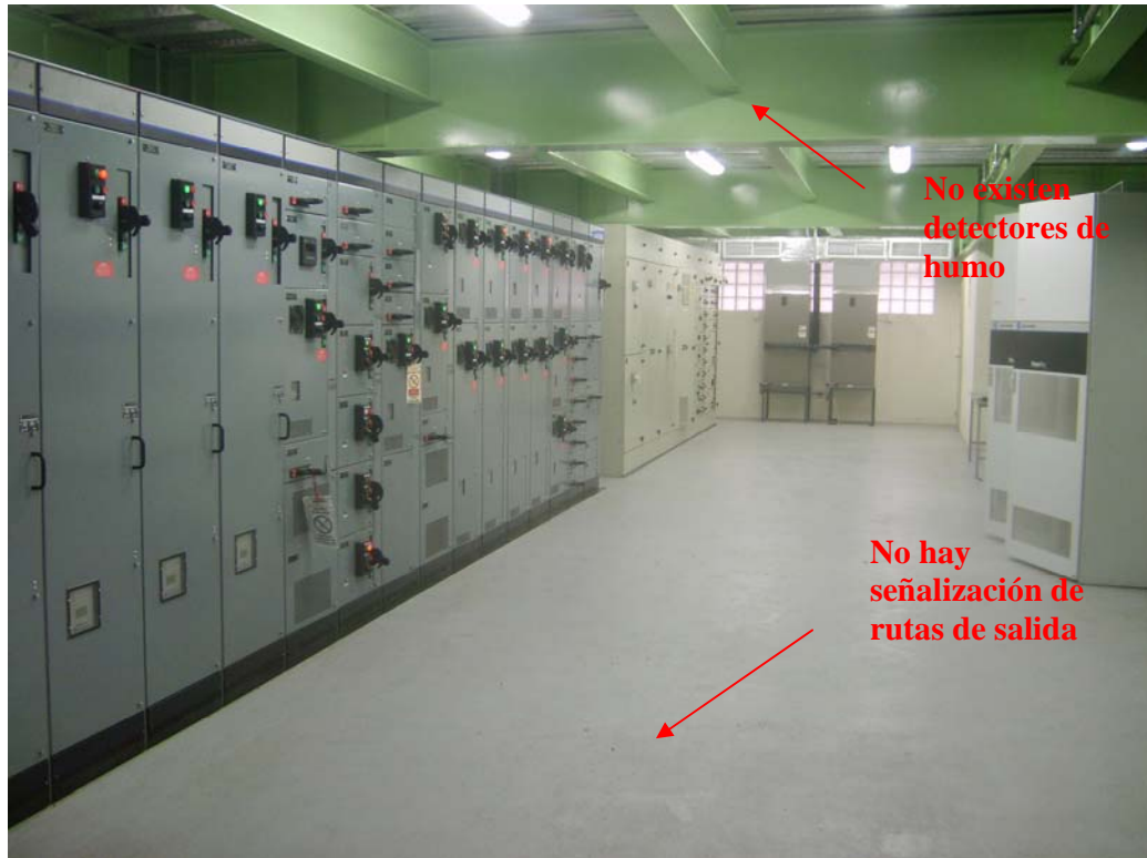
Figura 6.1 Cuarto del centro de control de motores (CCM)
