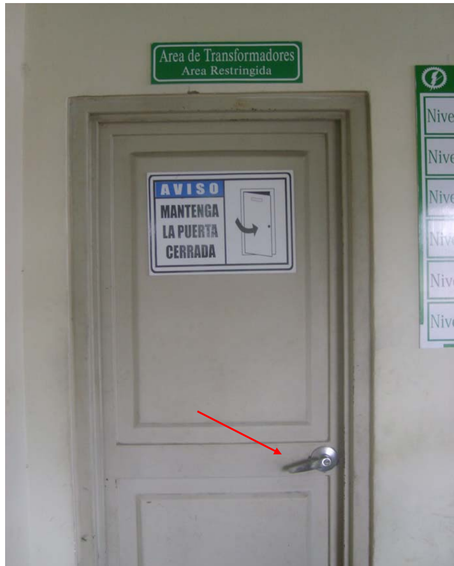
Figura 5.15 Cerraduras no adecuadas
