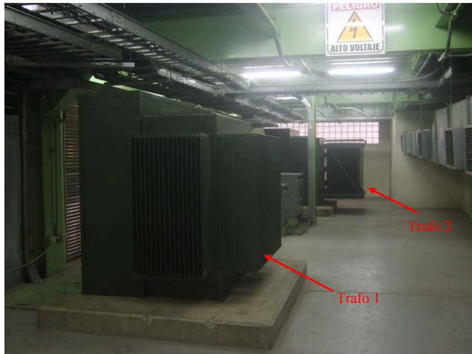
Figura 1.6 Cuarto de transformadores.
