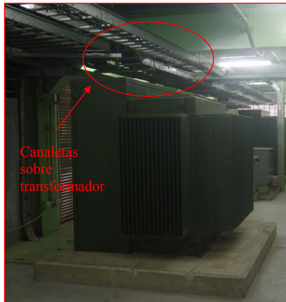
Figura 1.3 Canaleta no cumple con la ubicación
