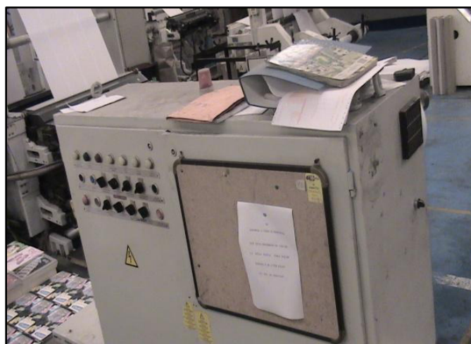
FIGURA 5.14: PANEL DE CONTROL ELÉCTRICO UTILIZADO COMO REPISA (ANTES).
