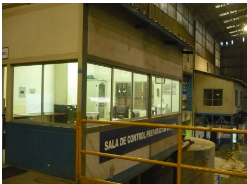
FIGURA 2.19: CUARTO DE CONTROL DE PREPARACIÓN DE PASTA
