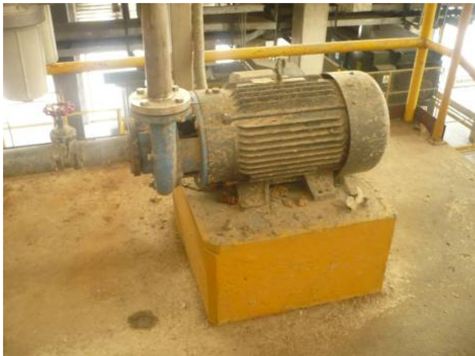
FIGURA 2.15 BOMBA DE DUCHAS DEL ESPESADOR.
