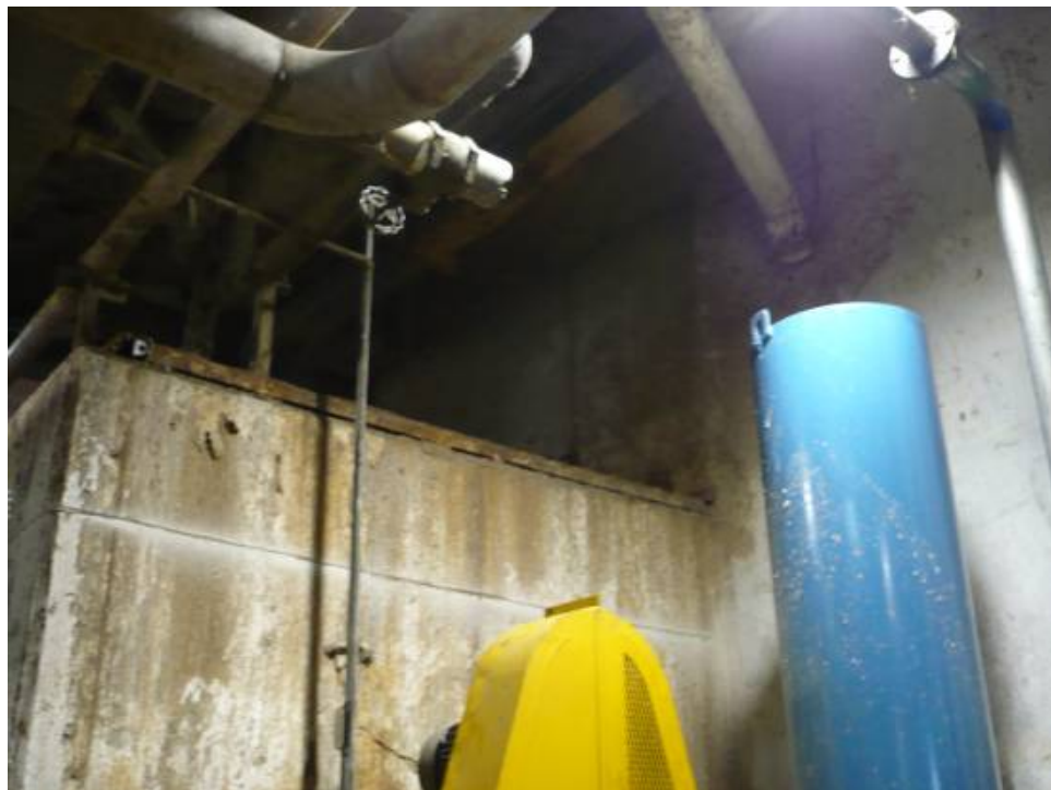
FIGURA 2.13 ACONDICIONAMIENTO DE STAND PIPE.
