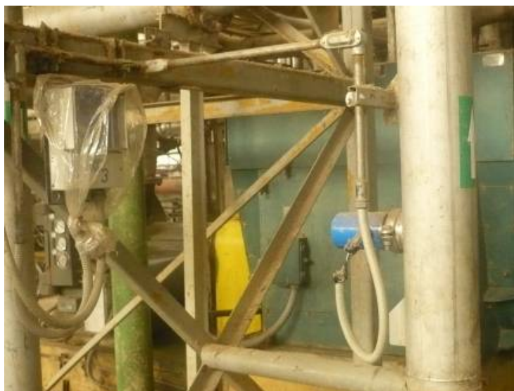
FIGURA 2.20: MEDIDOR DE CONSISTENCIA INSTALADO EN LA LÍNEA DE ALIMENTACIÓN AL REFINADOR DE FIBRA CORTA.
