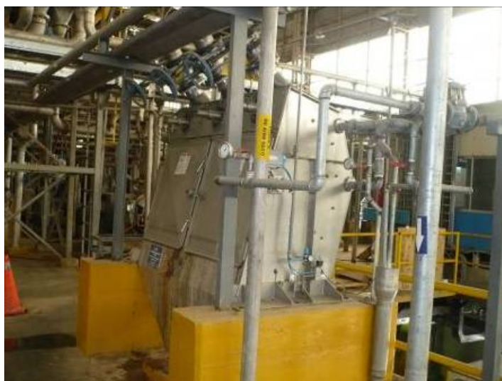
FIGURA 2.10 ESPESADOR DE FIBRA CORTA (INSTALACIÓN FINAL) A los equipos auxiliares que estaban existentes se les realizó trabajos de acondicionamiento para dejarlos aptos para la nueva aplicación de acuerdo a las siguientes figuras:
