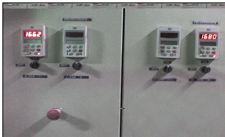
Foto N° 4.5.2 Variadores de velocidad bombas horizontales
