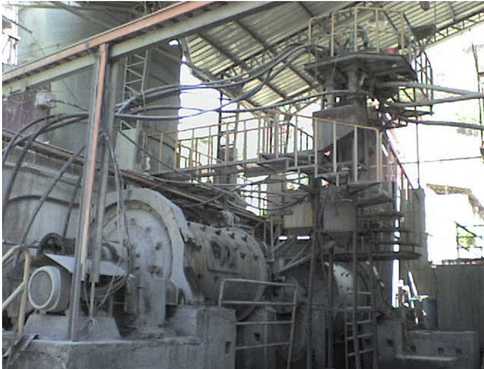
Foto N° 2.3 Circuito de Molienda
