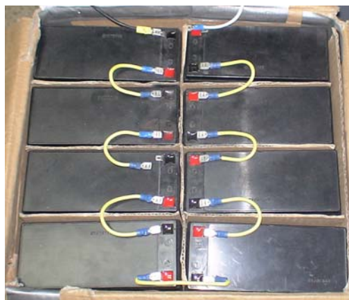
Fig. 3.46 Foto del banco de baterías.
