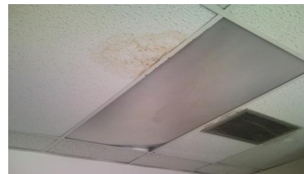
Figura 6. Techo con desperfectos.
