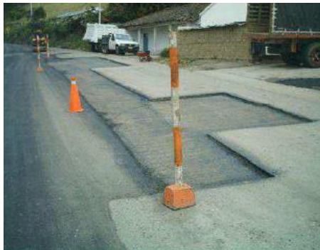
Figura 28. Parcheo en superficie de rodadura asfáltica
