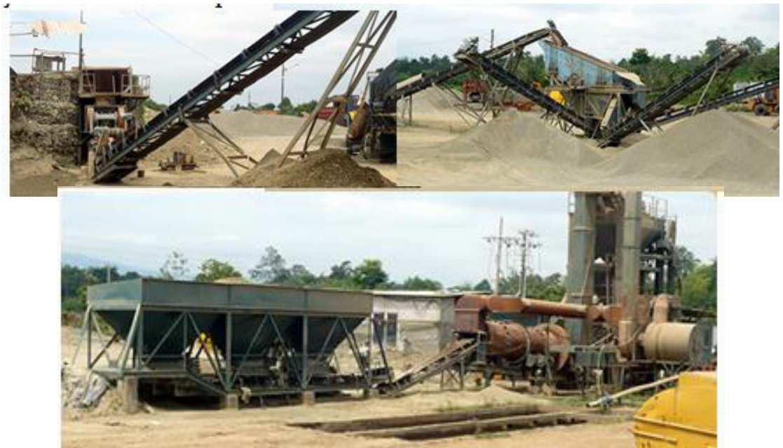
Figura 2. Planta de dosificación de los áridos
