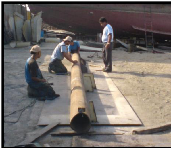
Figura N°11. Tubo para túnel del eje.
