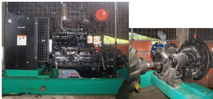
FIGURA 3.23: EQUIPO DE BOMBEO.
