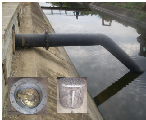
FIGURA 3.22: TUBERÍAS DE SUCCIÓN, CANASTILLA Y VÁLVULA CHEQUE.
