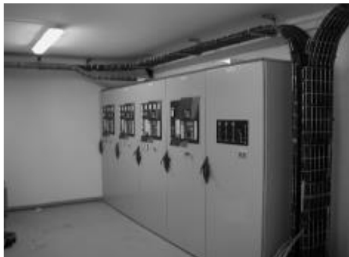
Figura 8. Tablero de transferencia
