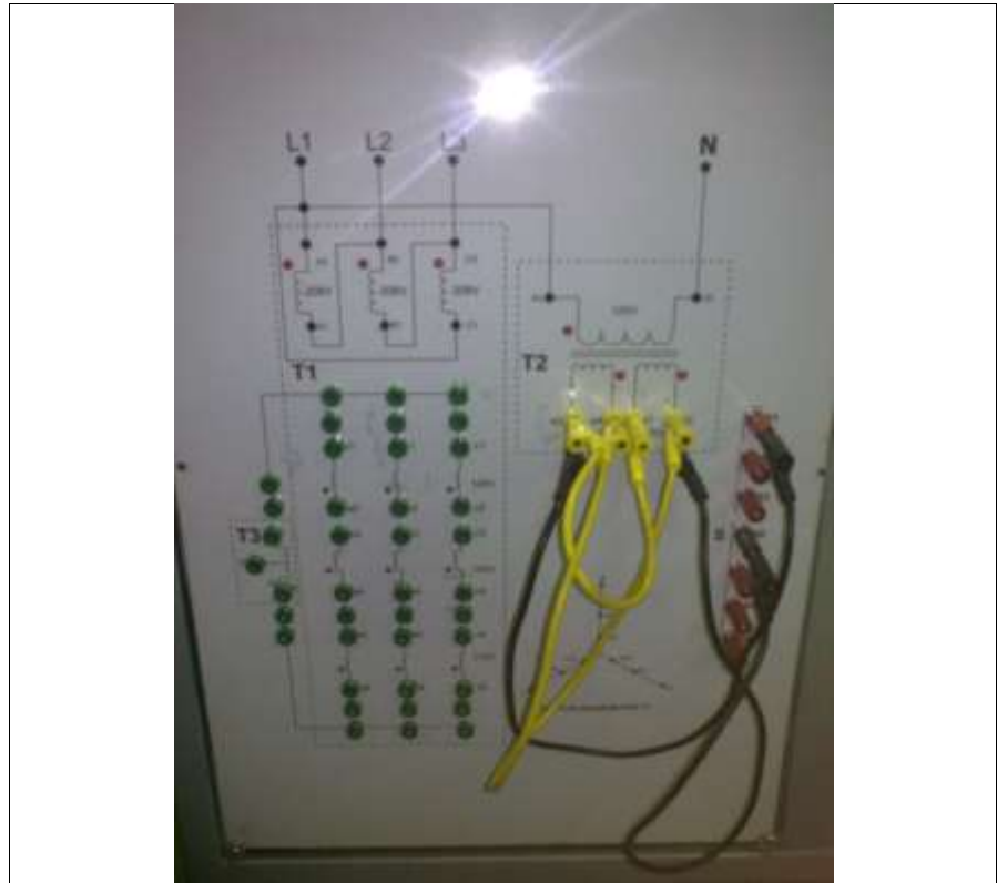
Figura 1.4 Fotografía de las conexiones del transformador T2 para el rectificador monofásico de media onda
