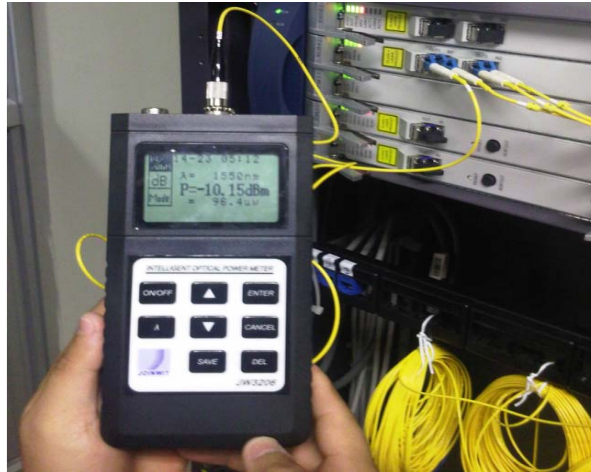
Figura 3.54 Medición de Potencia con el Power Meter
