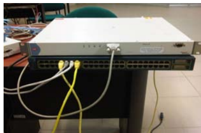
Figura 3.56 IPMUX8 y Switch Cisco 3550
