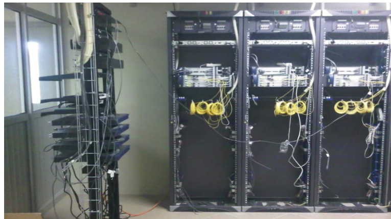
Figura 3.5 Distribución de los equipos activos en el laboratorio de telecomunicaciones
