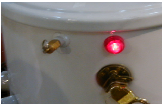
Figura 4.10. Breaker y luz piloto accionada.
