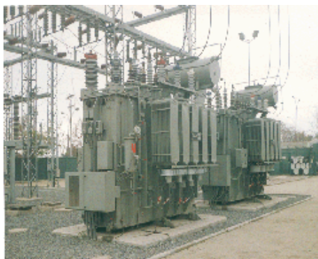
Figura 1.1. Transformador de potencia en subestación eléctrica
