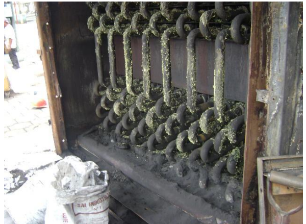
Cenizas y contaminación encontradas en el Economizador
