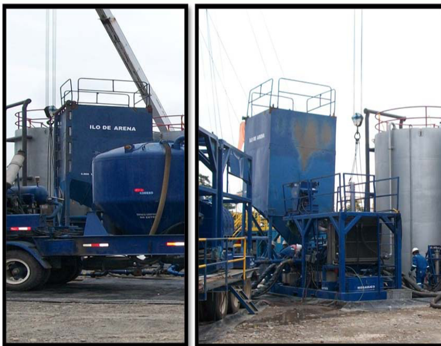
Fig. 5.6. Tanques de Almacenamiento de Agentes de Sostén
