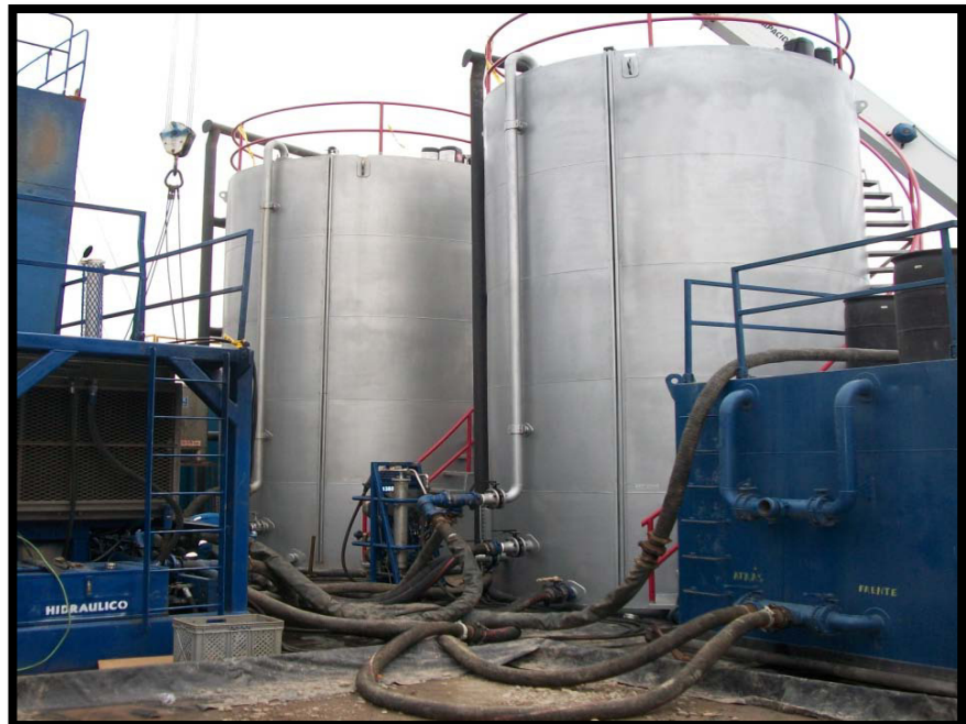
Fig. 5.5. Tanques de Almacenamiento de Gel Lineal
