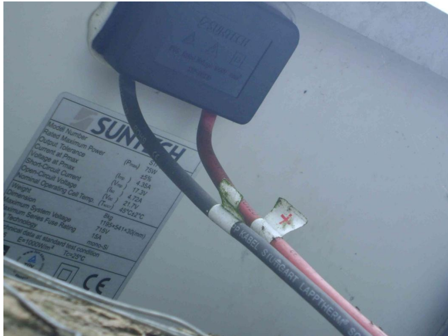
Figura 49.- Vista de la placa del panel solar
