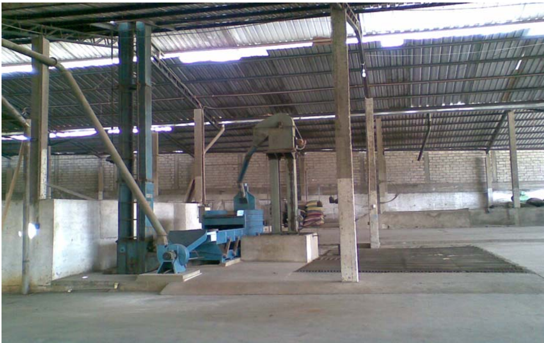
Instalaciones en Área de Secadora- Elevador
