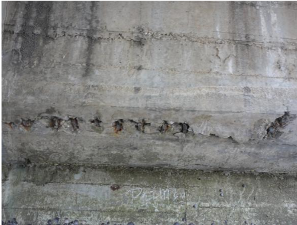
FIGURA 3.19: ROTURA DEL HORMIGÓN (FOTO P4-LM-E1)
