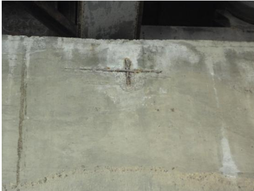
FIGURA 3.12: DESPRENDIMIENTO DEL HORMIGÓN Y CORROSIÓN EN LAS VARILLAS (FOTO P2-LM ENTRE C1 Y D1)
