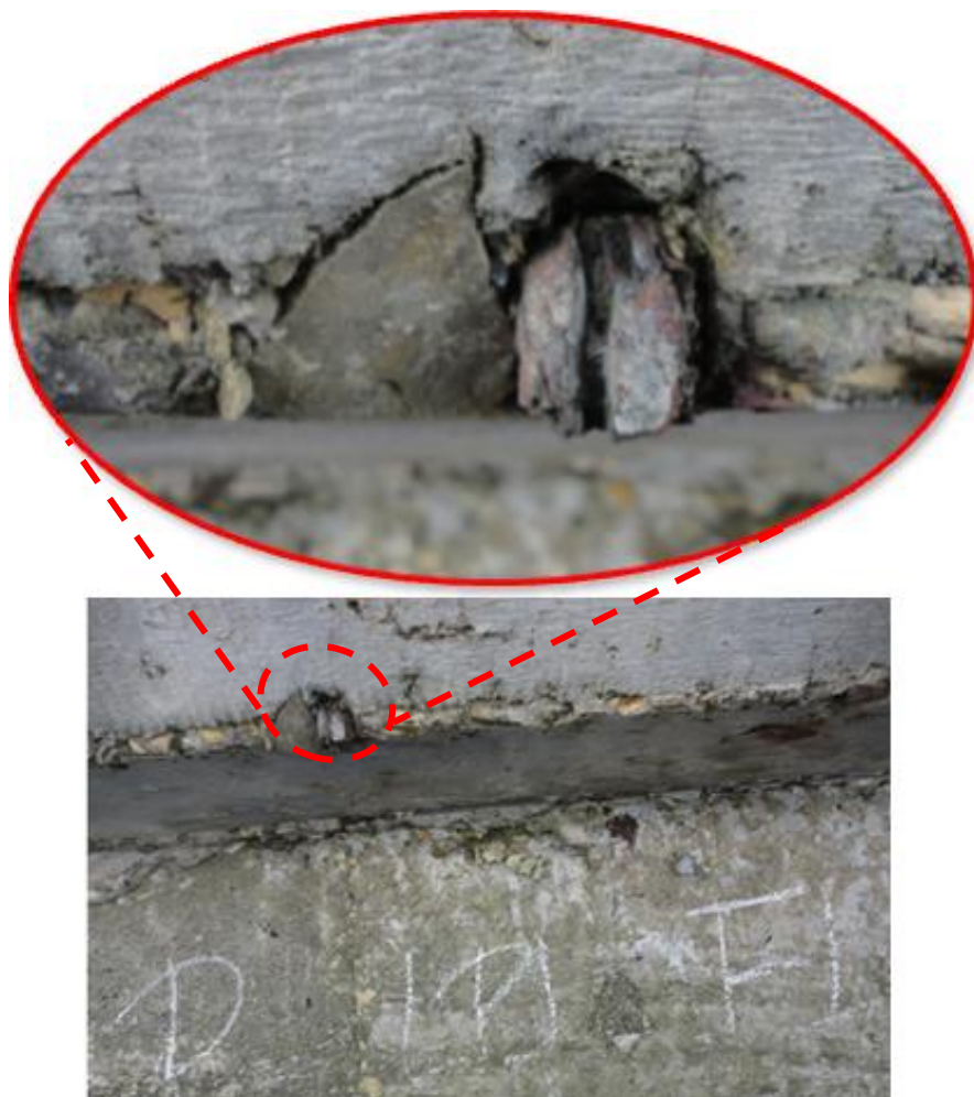
FIGURA 3.16: VARILLA CORROÍDA (FOTO P4-LP-F1)
