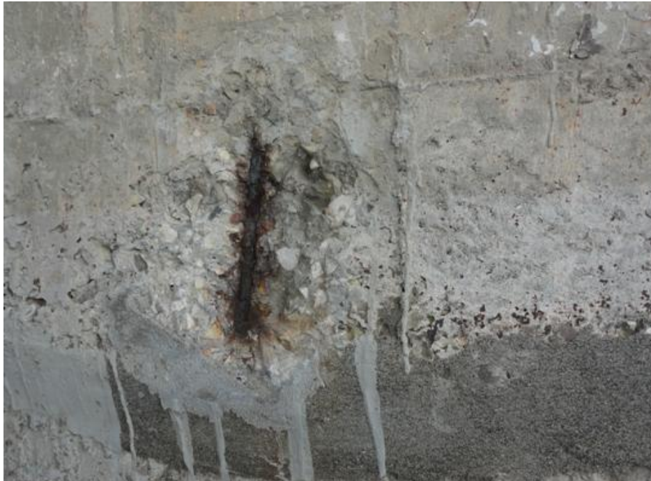
FIGURA 3.14: ROTURA DEL HORMIGÓN (FOTO P3-LP ENTRE B2 Y C2)
