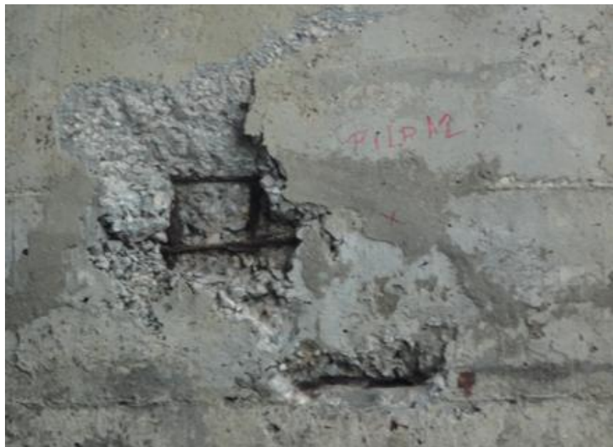
FIGURA 3.9: ROTURA DEL HORMIGÓN (FOTO P1-LP-A2)
