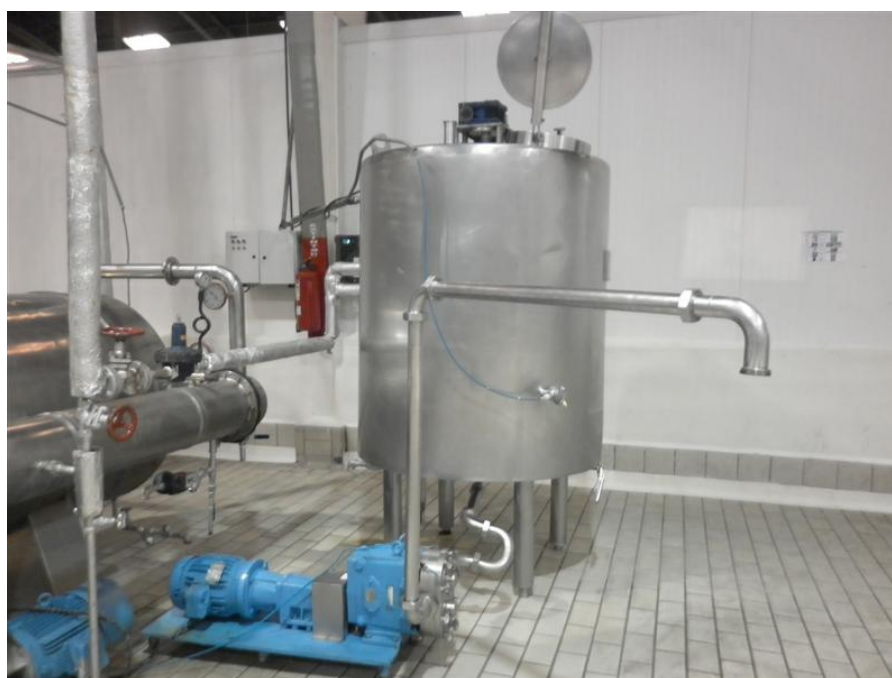
Figura 3.8: Tanque Enchaquetado Instalado en Planta.
